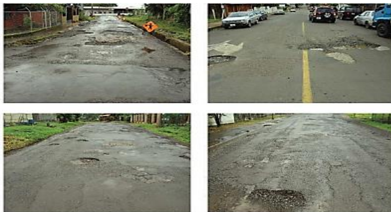
Figura 6: Daños por humedad en vías Nacionales
