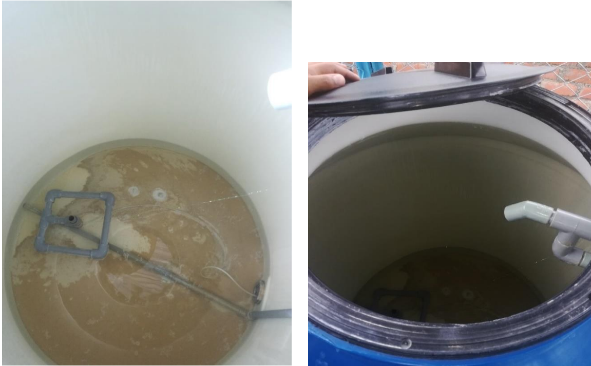
Imagen N° 10: tanque de cloración inoperativo
