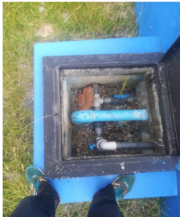
Imagen N° 11: instalaciones de tuberías del reservorio
