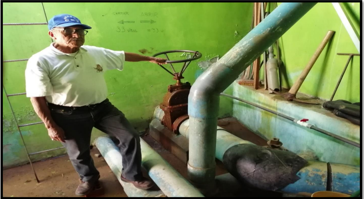
Instalaciones al interior del reservorio de Shekpa y el encargado de su mantenimiento
