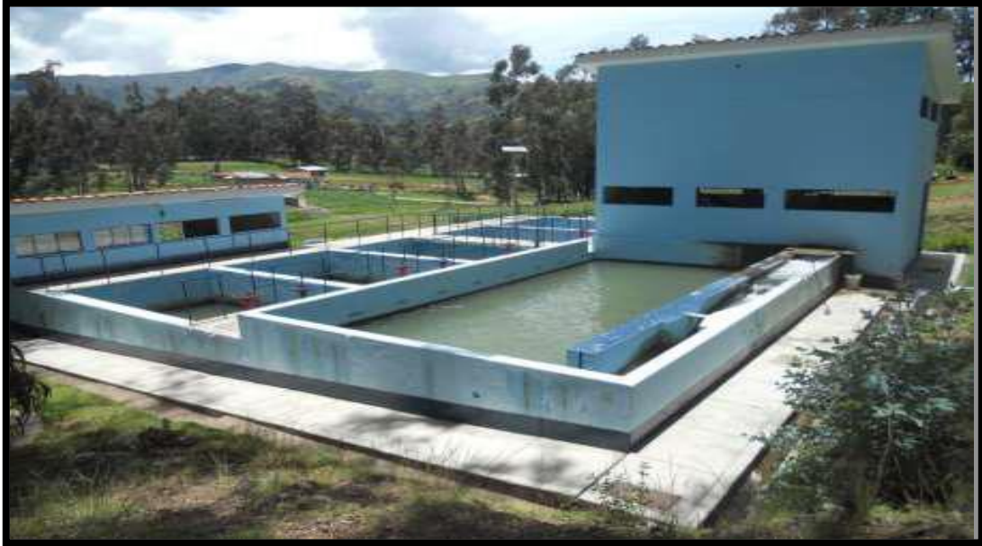
Planta de Tratamiento de la EPS Chavín ubicado en Marian
