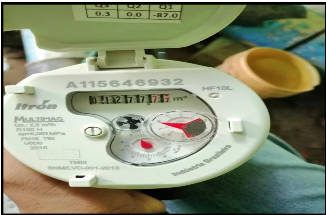
Instrumento de medición de caudal, usado en la línea de conducción inicial saliente del reservorio (Durante y después de la medición)
