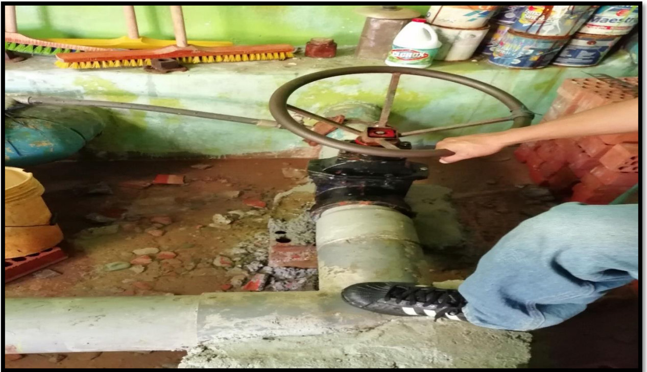
Instalaciones al interior del reservorio ubicado en Shekpa, se puede apreciar el deterioro de estos mismos
