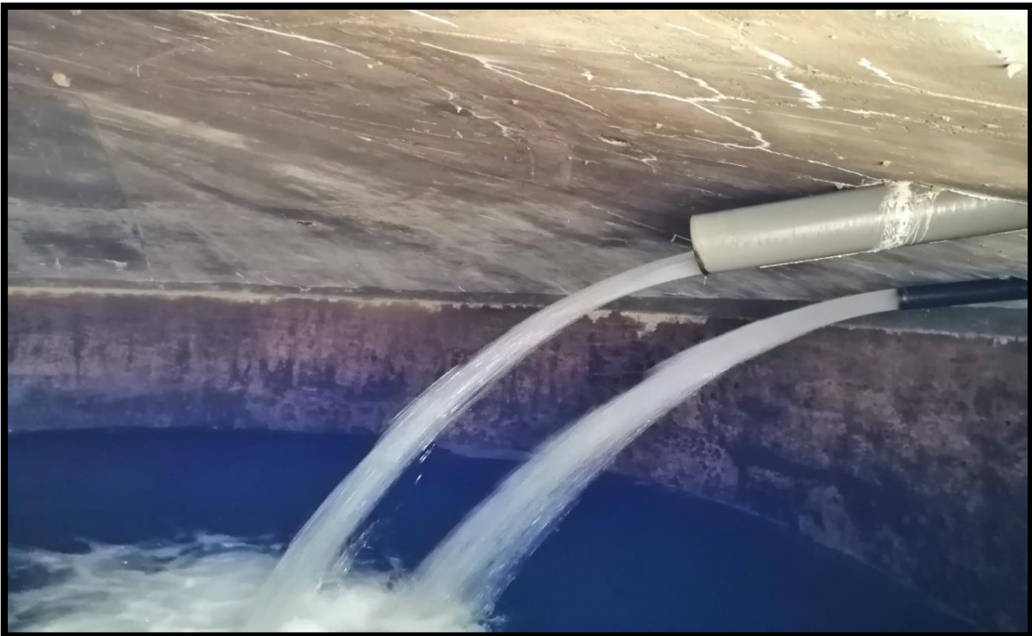
Linea de conducción de la planta de tratamiento al reservorio, tienen un diametro de 8''
