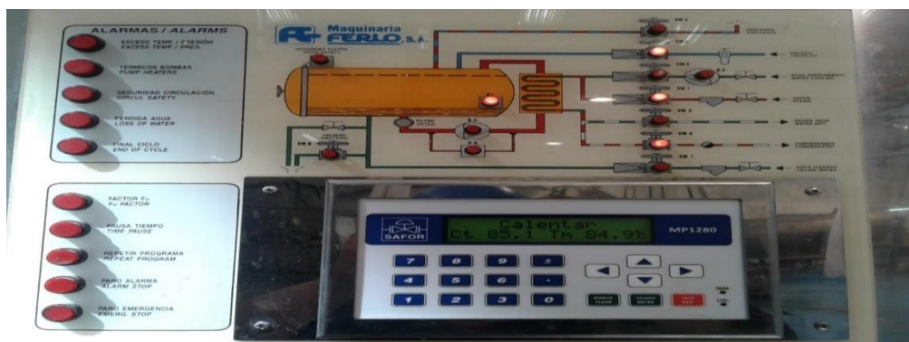
Figura 10: Panel de control autoclave ferlo.
