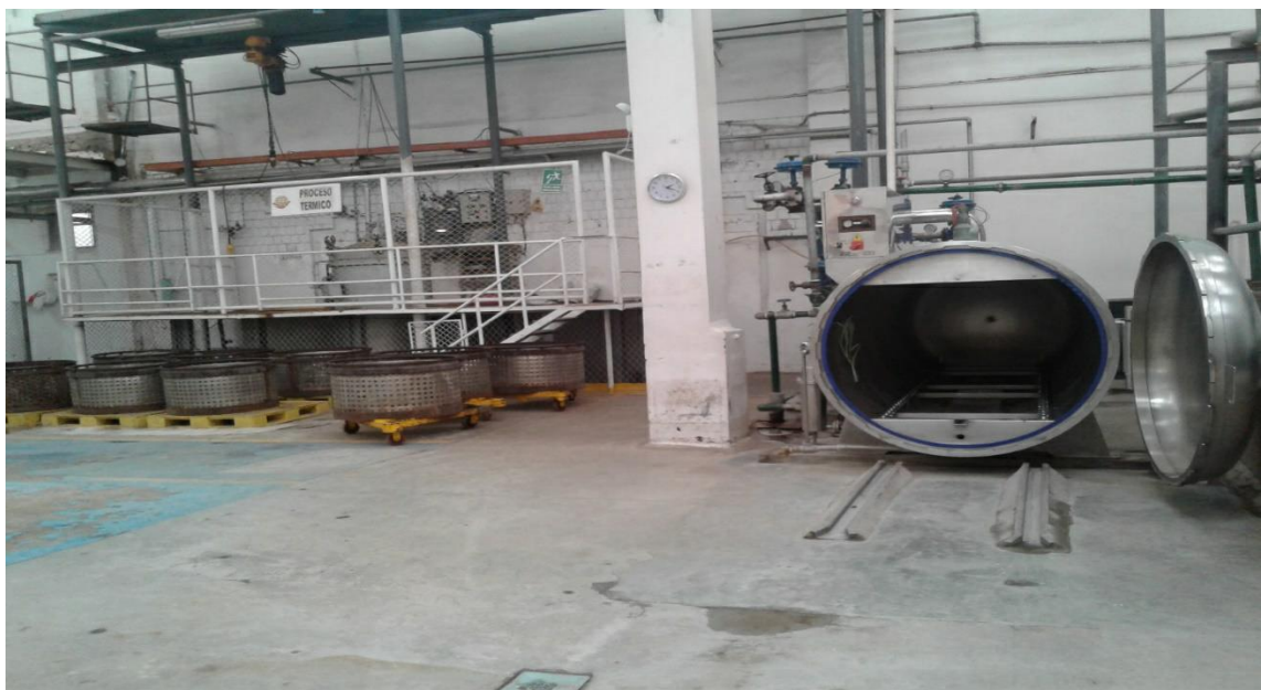
Figura 1: Foto del estado actual de autoclaves en Procesadora Perú.
