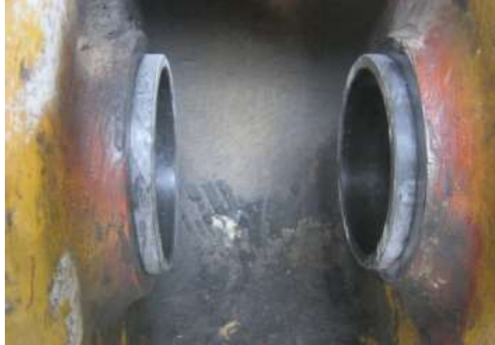
Figura n°13. Alojamiento de las bocinas de bakelita. Fuente. Elaboración propia.
