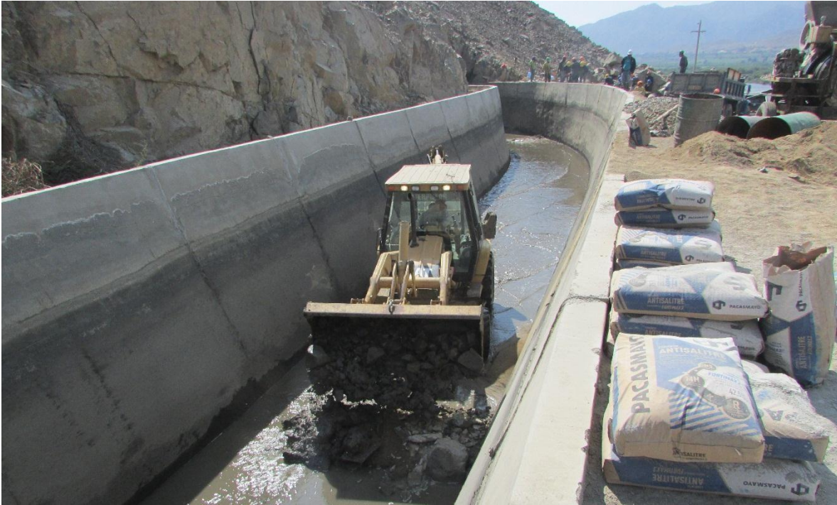
Fotografía. N° 17. Se observa en la imagen los trabajos de mantenimiento por parte del área de OPEMAN perteneciente al PE-CHINECAS.
