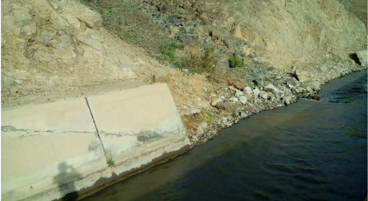
Fotografía. N° 05. En la imagen se aprecia el margen izquierdo del canal colapsado, asimismo se aprecia partículas grandes al entorno entre flujo de canal y la quebrada.
