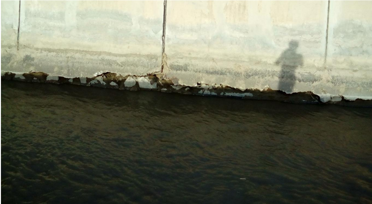
Fotografía. N° 07. En la imagen se puede apreciar en el margen izquierdo del canal grietas longitudinales ubicadas en el entorno del tramo más afectado que es el área de manteniendo ubicada en la progresiva 11+850.
