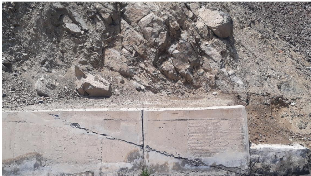
Fotografía. N° 21. Se observa en la imagen una grieta diagonal en el margen izquierdo del canal “IRCHIM”, producto del empuje del caudal de la escorrentía activada en la quebrada.
