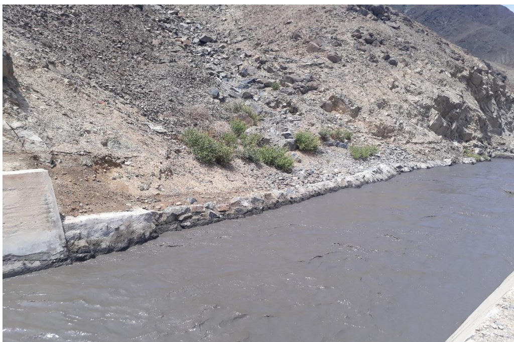
Fotografía. N° 22. Se observa en la imagen el colapso del margen izquierdo de la infraestructura con material de mampostería.
