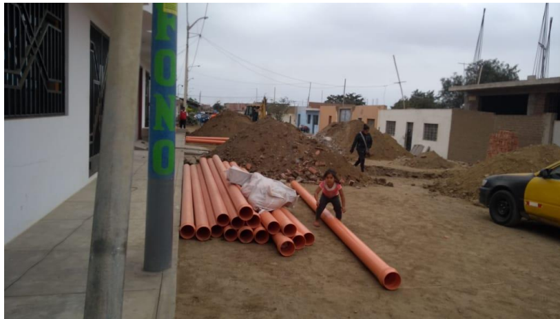
Figura 43: Trabajo de obras del tendido de redes de la empresa SEDALIB S.A
