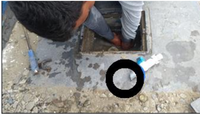
Figura 25: Trabajo mal ejecutado por falta de capacitación y malas técnicas de trabajo
