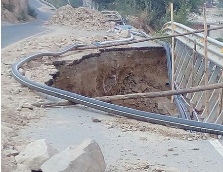
Figura 01. Daño severo en carril de la vía alterna de la carretera central
