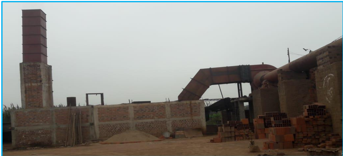
Figura 20. Filtro lavador de gases
