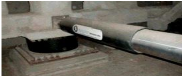
Figura 2. Instalación de los disipadores viscosos Taylor
