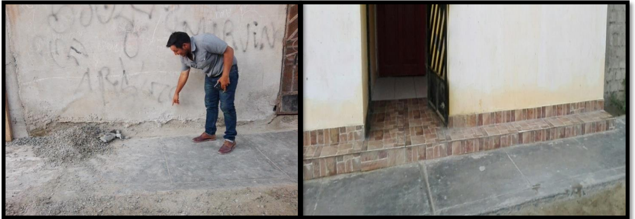
IMAGEN N° 2: Paredes húmedas Fuente: Elaboración propia.
