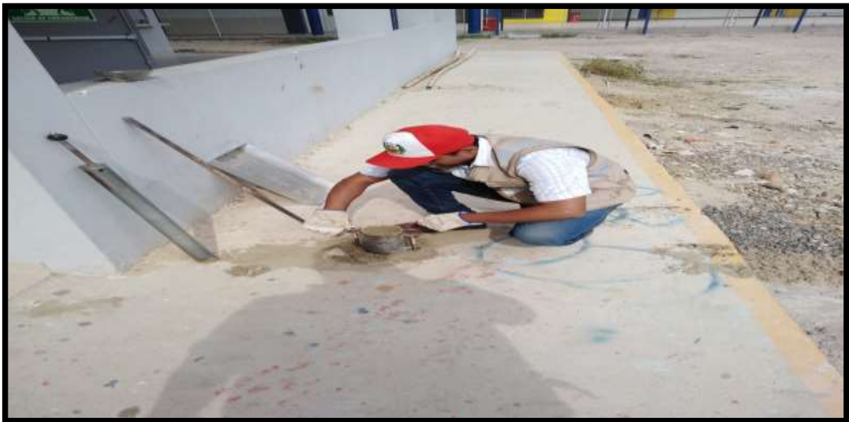
FIGURA N°61: Se observa la elaboración del ensayo del CBR de las 4 muestras extraídas de las zonas para calcular las propiedades físicas y mecánicas del suelo.
