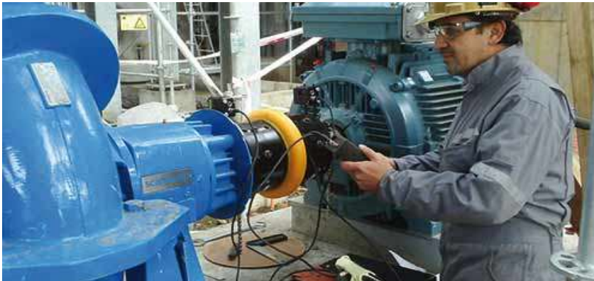
Figura nro. 46. Alineamiento de ejes motor y bomba con rayos láser.
