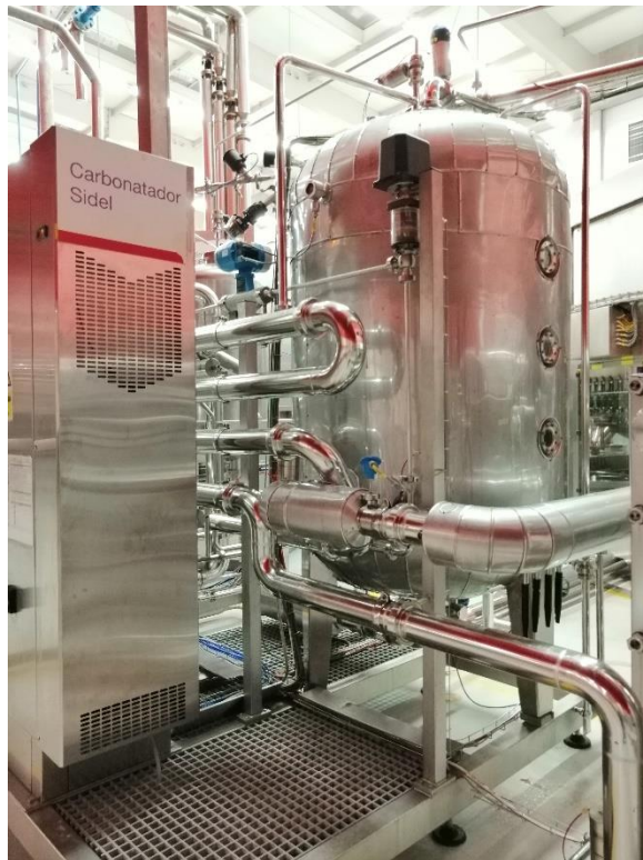
FIGURA 6. SISTEMA DE CARBONATACIÓN.
