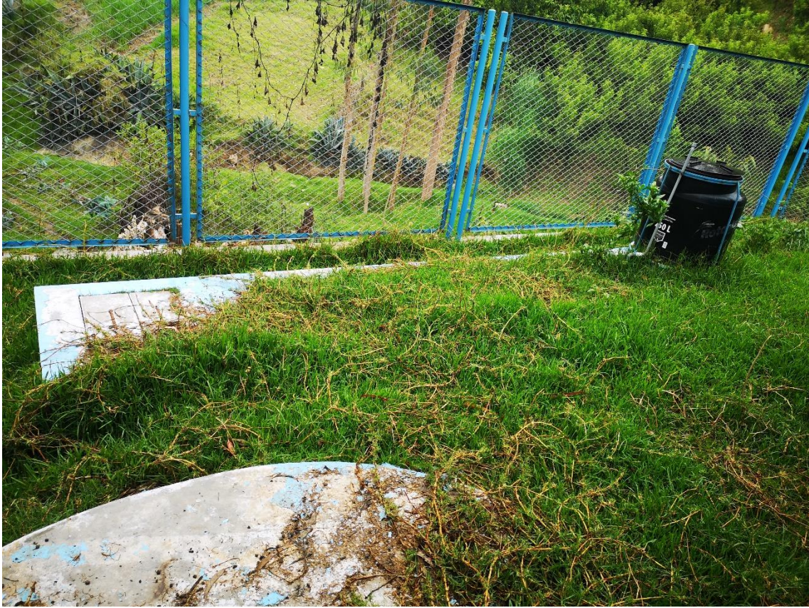
Figura 31 Evaluación de patologías en el Contacto de Cloro
