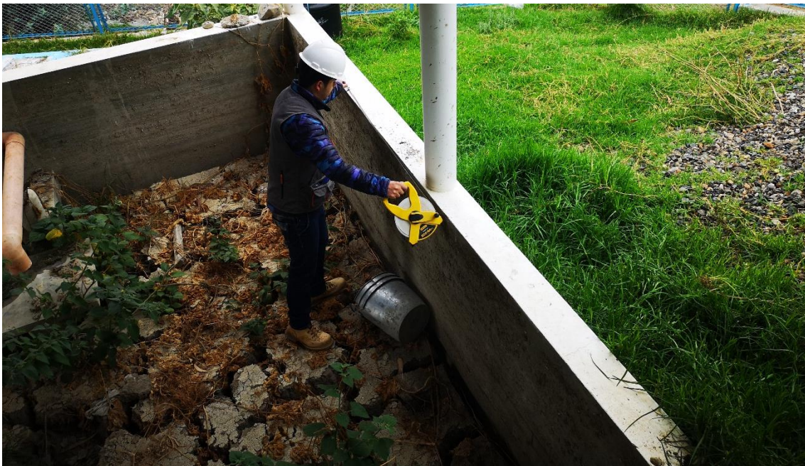
Figura 26 Evaluación de patologías en el Lecho de Secado
