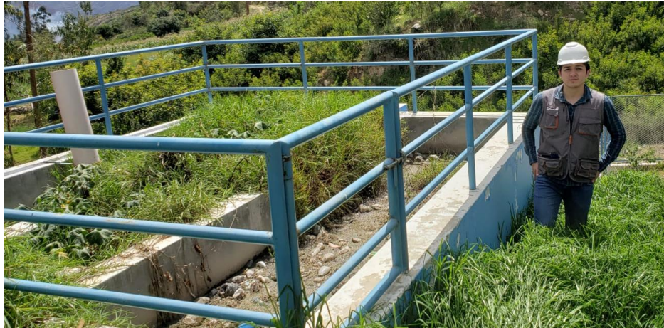
Figura 15 Evaluación de patologías en el Tanque IMHOFF
