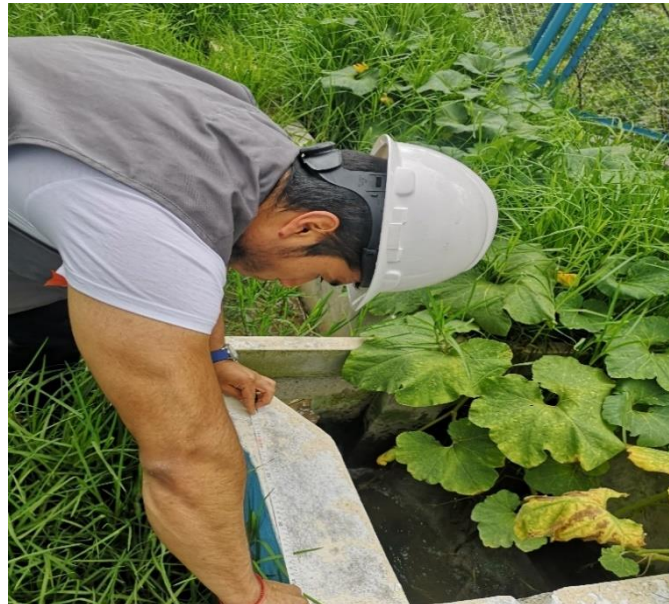
Figura 10 Evaluación de patologías en la Cámara de rejillas
