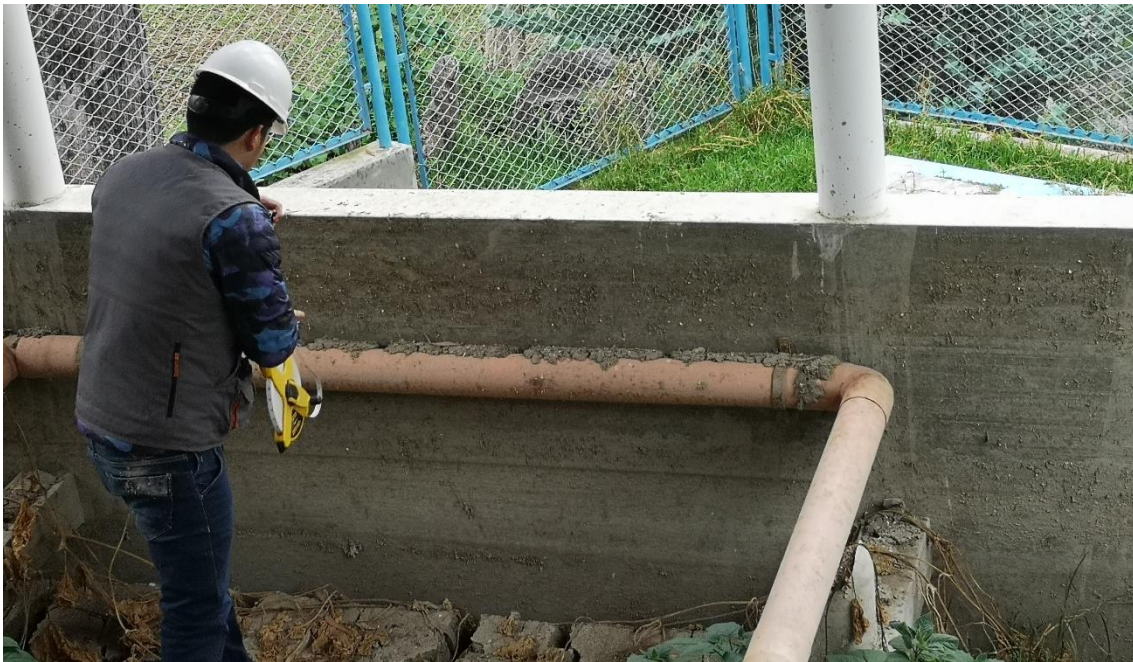
Figura 25 Evaluación de patologías en el Lecho de Secado
