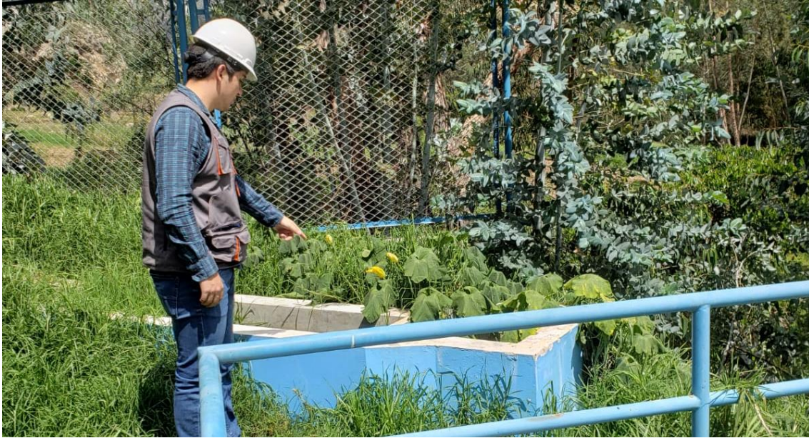
Figura 11 Evaluación de patologías en la Cámara de rejas
