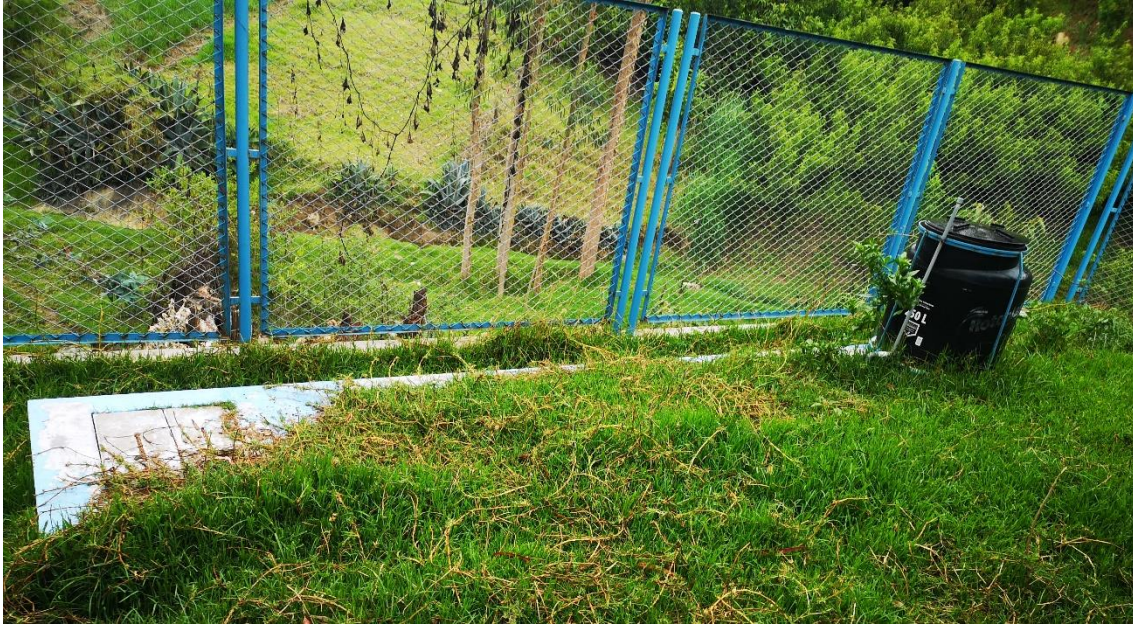
Figura 29 Evaluación de patologías en el Contacto de Cloro
