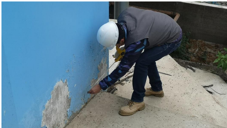
Figura 16 Evaluación de patologías en el Tanque IMHOFF
