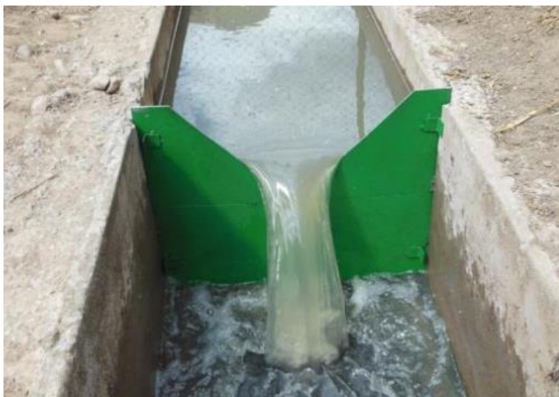
Figura 4 Aplicación del vertedero triangular en el conducto de salida de la PTAR
