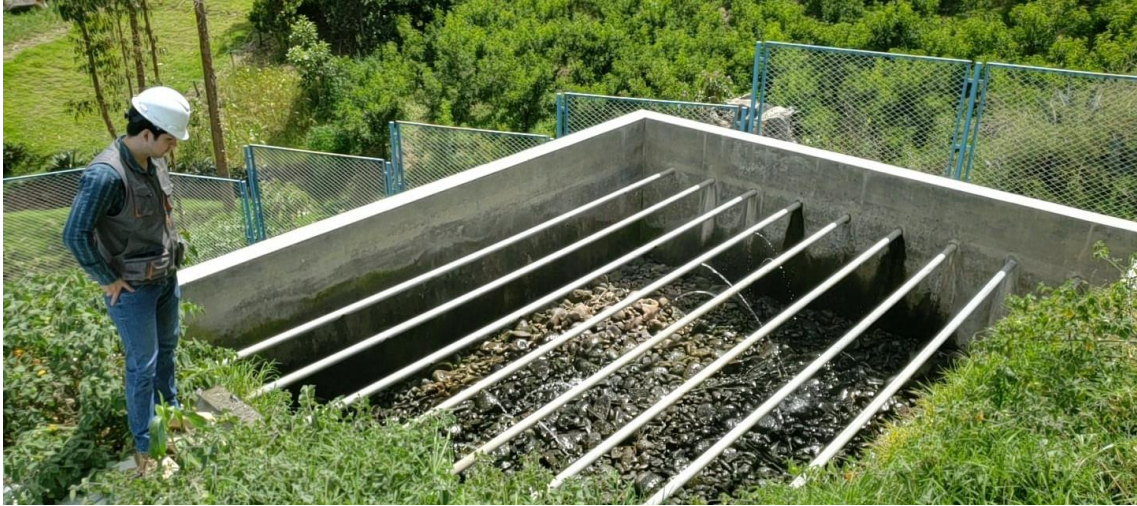
Figura 20 Evaluación de patologías en el Filtro Biológico
