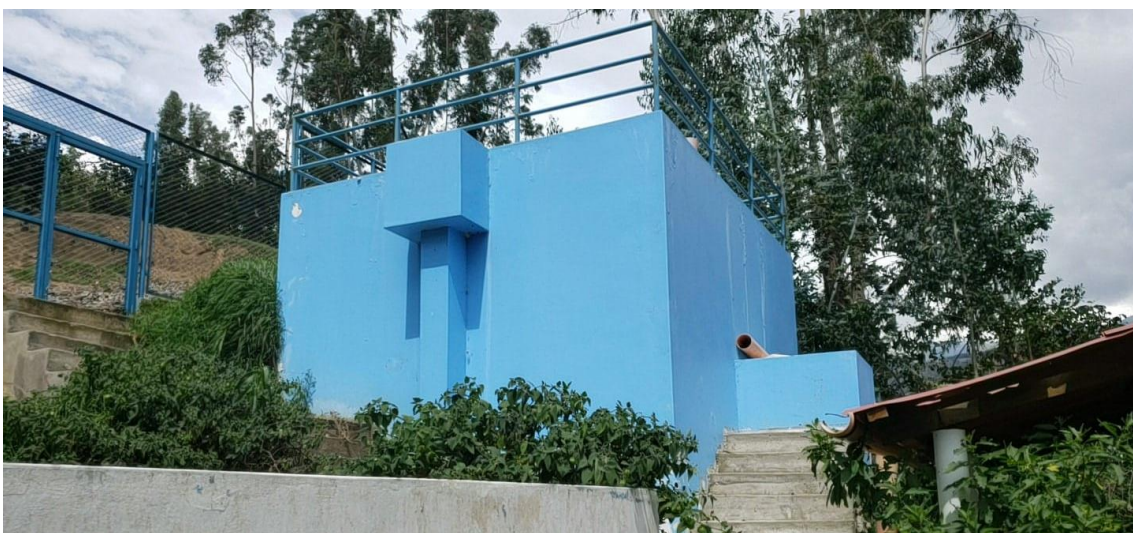
Figura 14 Evaluación de patologías en el Tanque IMHOFF
