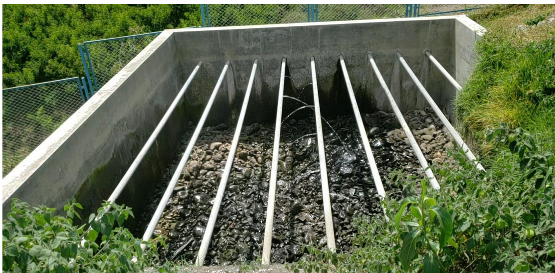
Figura 19 Evaluación de patologías en el Filtro Biológico
