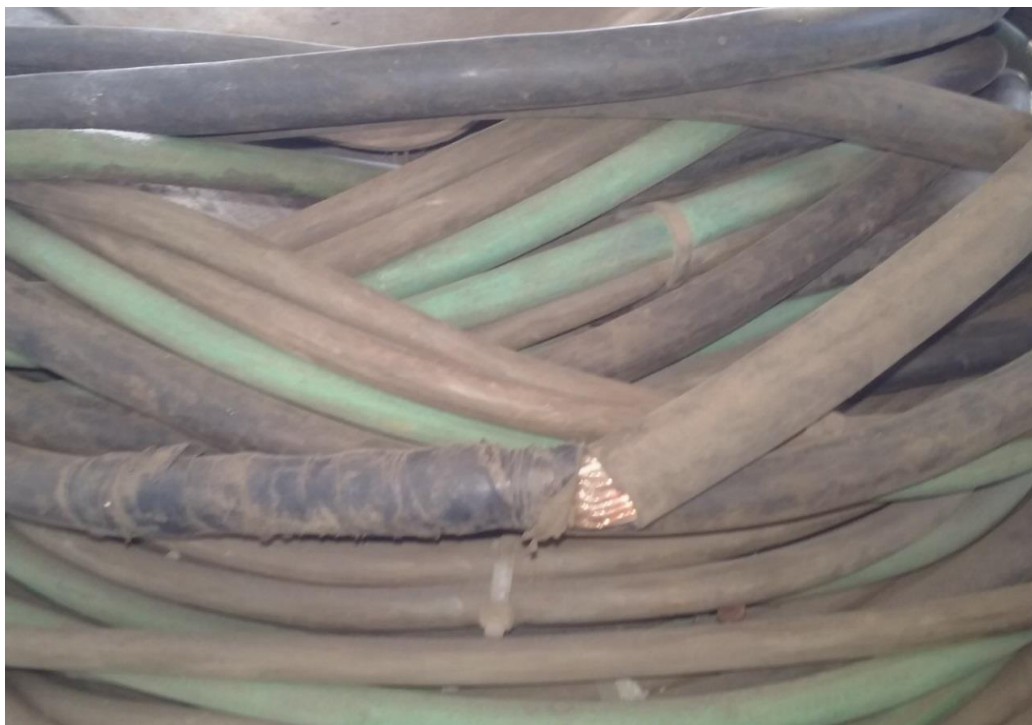
Figura 34: Actividad: Locativo Riesgo: Físico / Taller obstruido con material apilado, Cable en mal estado
