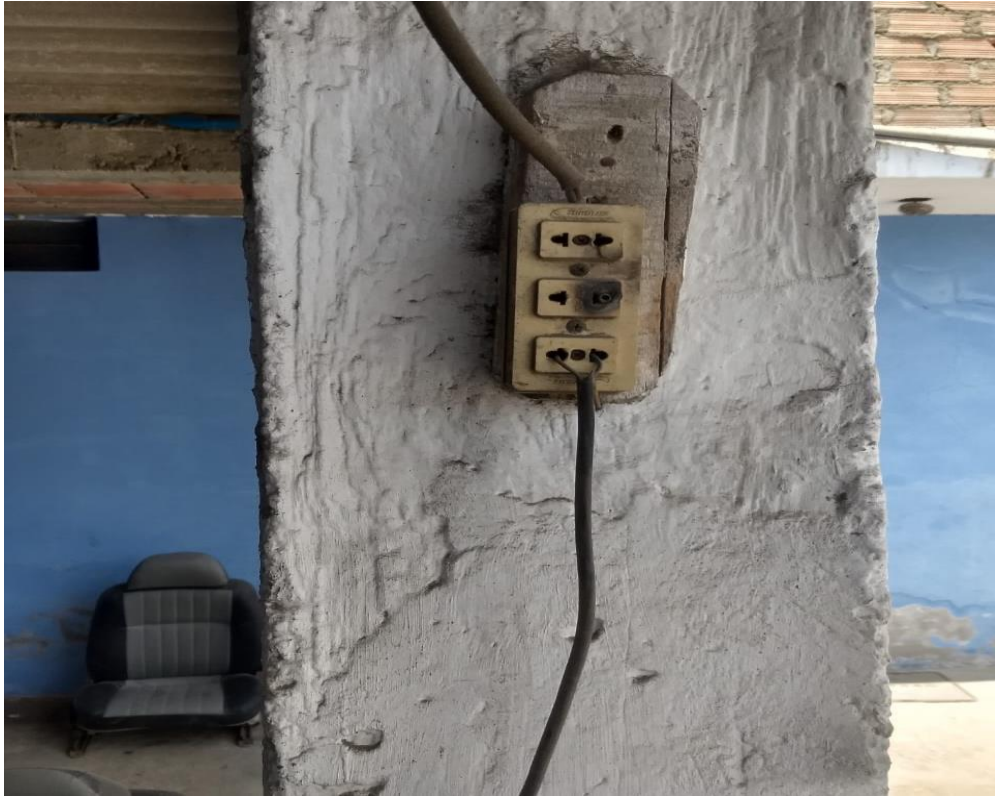
Figura 41: Instalaciones eléctricas inadecuadas
