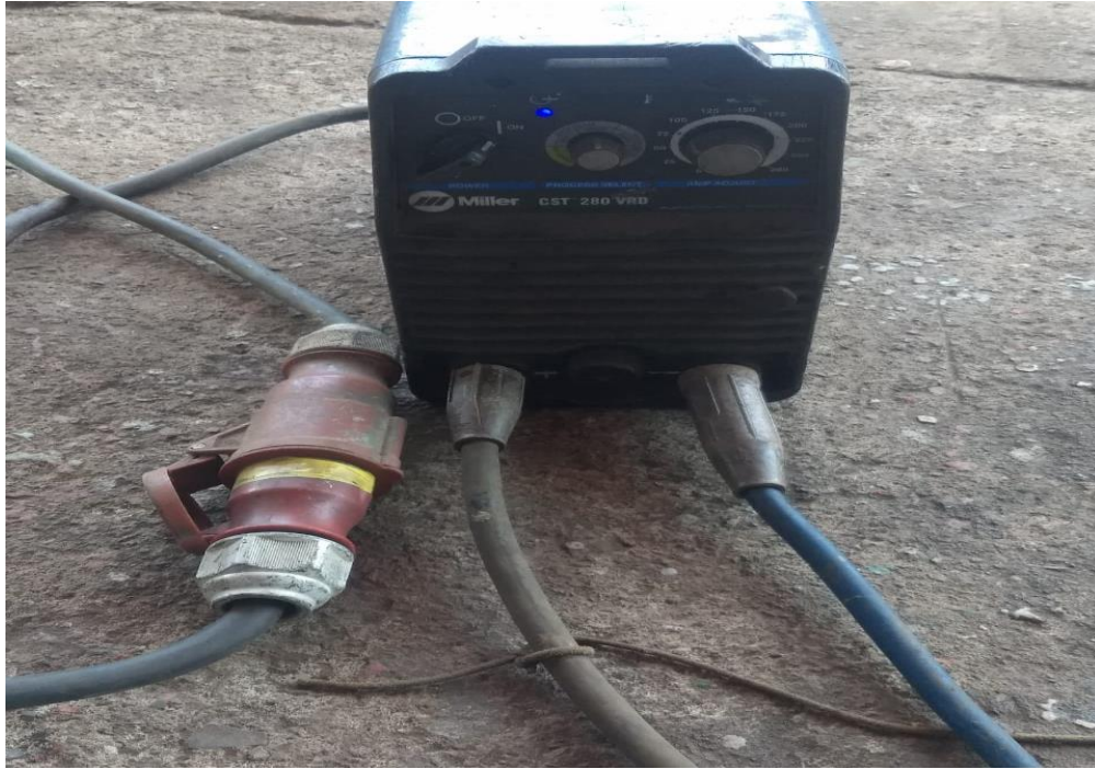
Figura 29: Actividad: Soldar Riesgo: Físico/ Eléctrico Propuesto: Utilización de carriles conductores en el cableado. Propuesto: Colocación de extintor.
