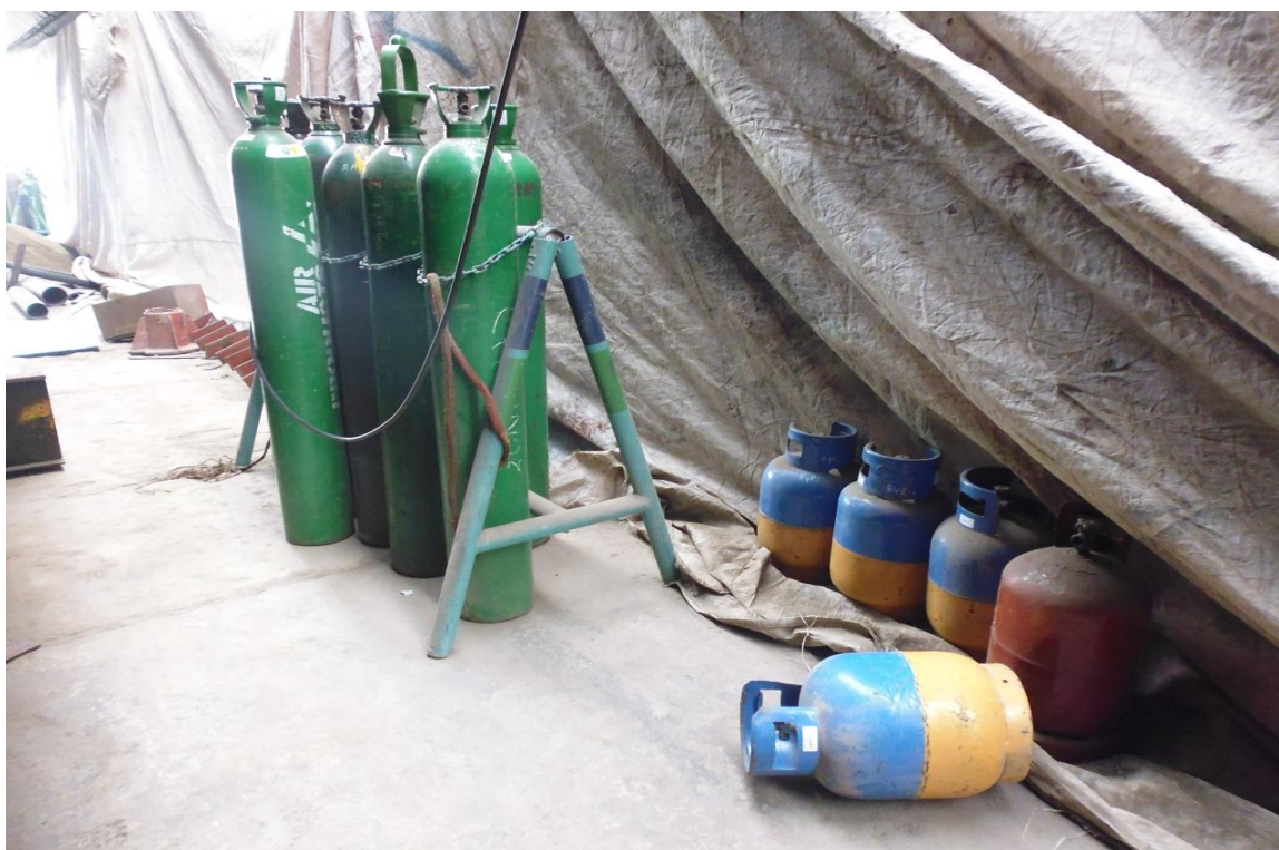
Anexo N° 36: Botellas de oxígeno y gas expuestas en área de operaciones.
