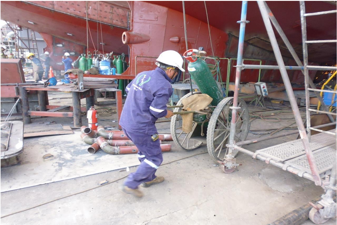
Anexo N° 27: Traslado de tanques o botellas al patio de operaciones.
