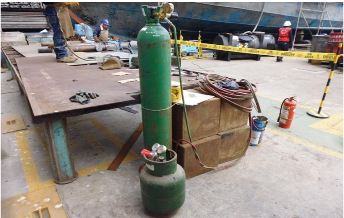
Anexo N° 28: Botella instalado en el patio de operaciones.
