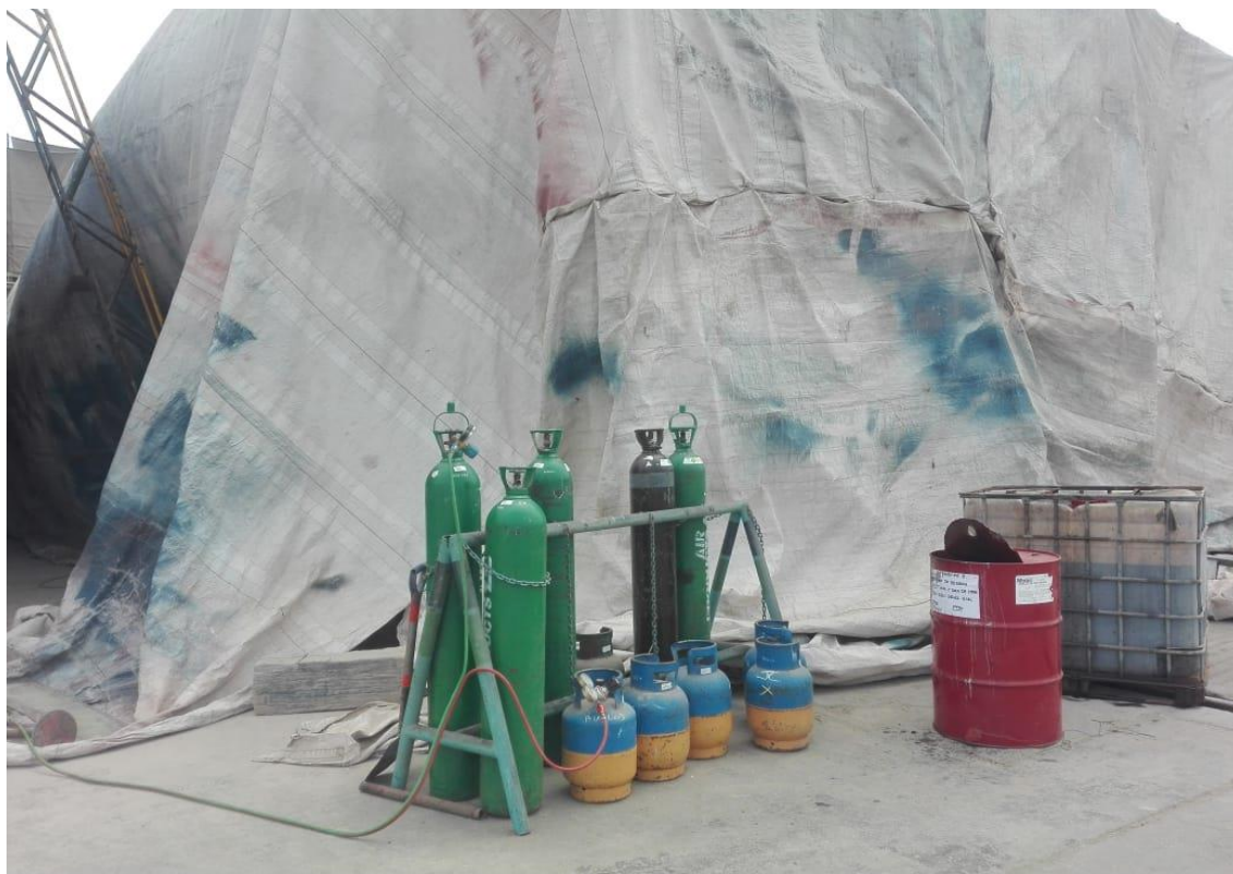
Anexo N° 35: Botellas de oxígeno y gas expuestas en área de operaciones.
