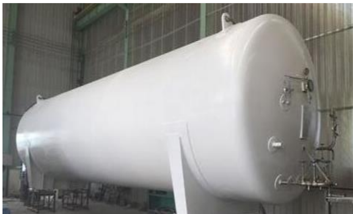
Anexo N° 38: Estación de tanque criogénico
