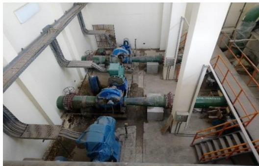
Figura 2. Estación de bombeo ETAB-01, EPSEL
