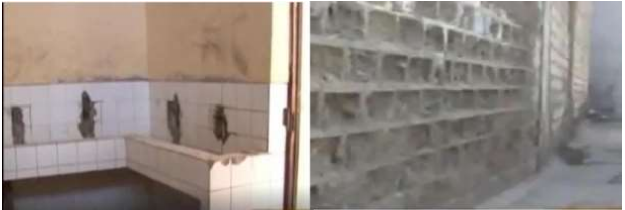
Figura 34. Los servicios higiénicos se encuentran clausurados debido al deterioro de estos ambientes y al inexistente mobiliario con el que cuentan.
