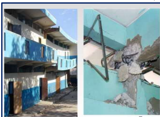
Figura 13 – Instituciones educativas con columnas cortas en sus aulas (sismo Arequipa 2001)
