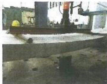
Figura 19. Vista de la flecha producida por la carga
