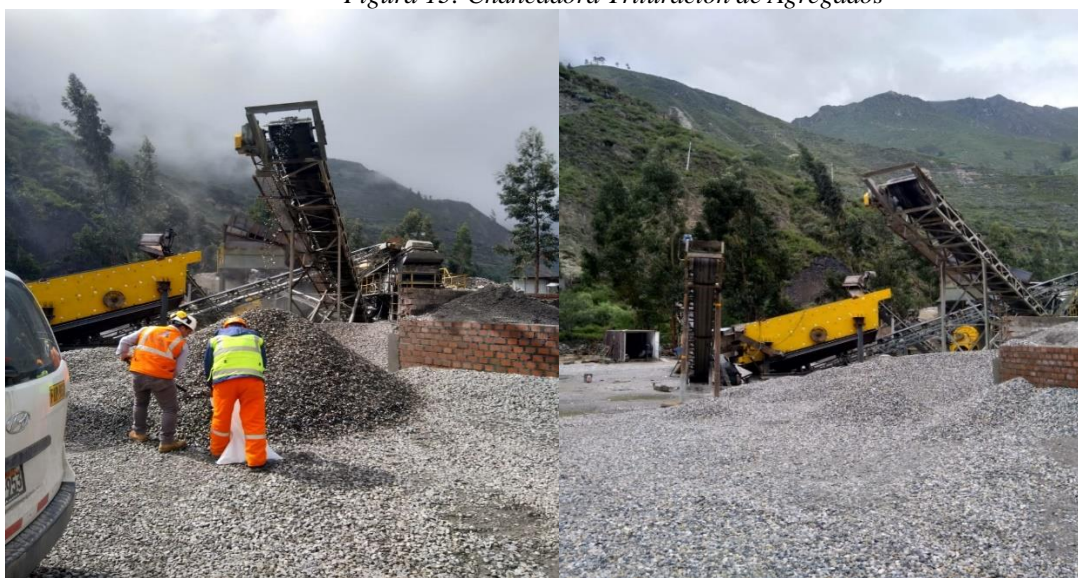
Figura 13: Chancadora Trituración de Agregados
