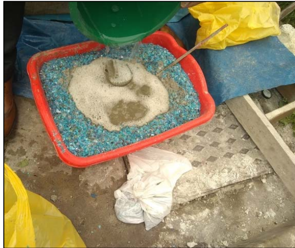
Figura 14. Mezcla de insumos
