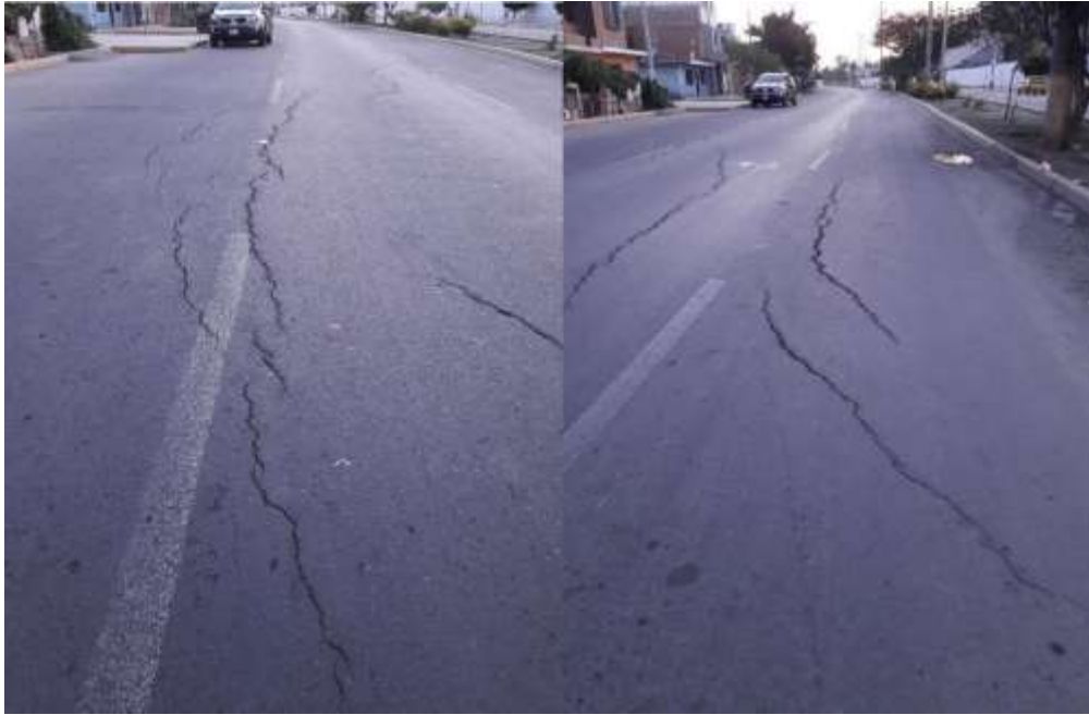
GRÁFICO N° 5 Y 6: TOMA DE MUESTRA GRIETAS LONGITUDINALES
