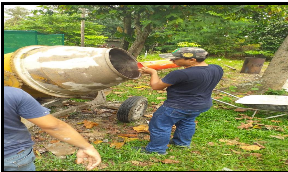
Fig. N °09: se observa la realización de la mezcla, con la dosificación obtenida y con la supervisión de los expertos.
