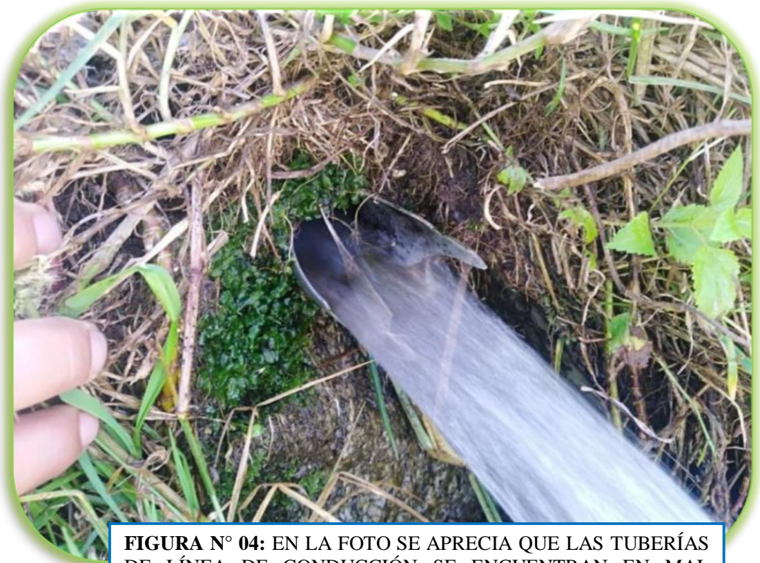
FIGURA N° 03: EN LA FOTO SE APRECIA QUE LAS TUBERÍAS DE LÍNEA DE CONDUCCIÓN SE ENCUENTRAN EN MAL ESTADO POR LAS FUGAS QUE POSEE.
