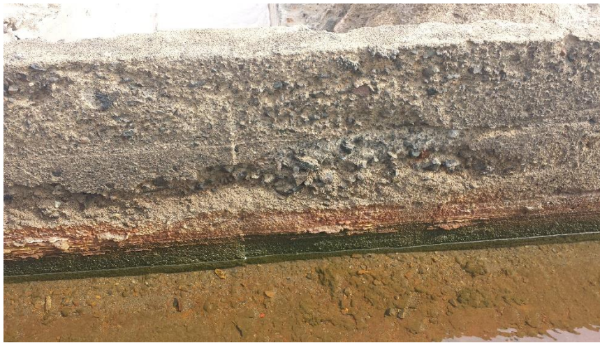
Figura 1: Estructuras de concreto armado deterioras por el salitre – Huaura 2019
