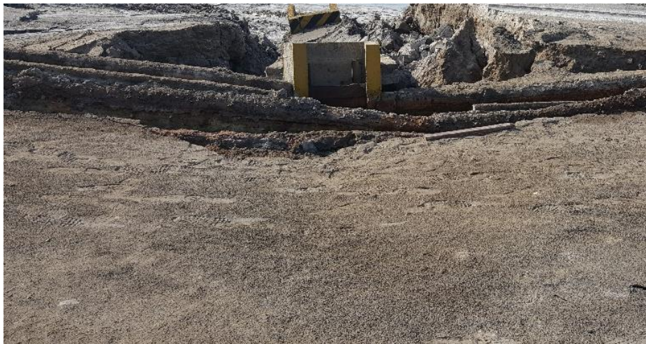
Figura 3: falla estructural ocasionadas por deterioro por salitre – Huaura 2019
