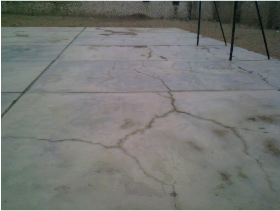
ÁREA DE LOSA DETERIORADA E INTERIOR DEL COMPLEJO
