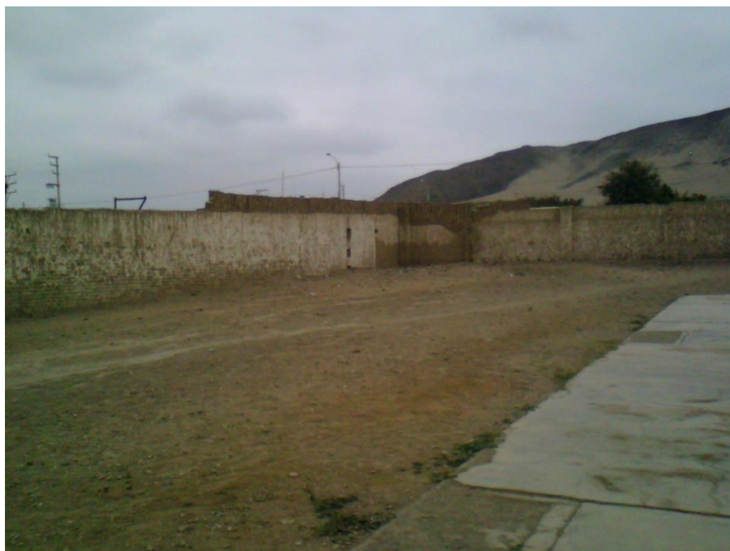
MUROS DE ADOBE DETERIORADOS
