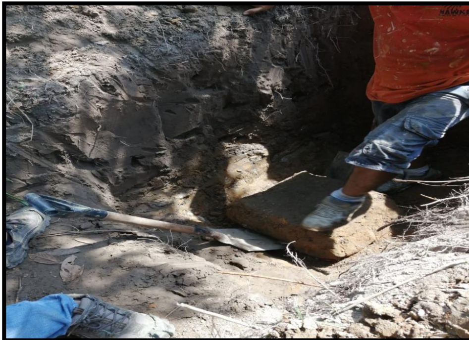
(foto N° 4) En la imagen podemos observar la extracción del cubo para realizar la prueba de corte directo en el laboratorio de la Universidad Cesar Vallejo.
