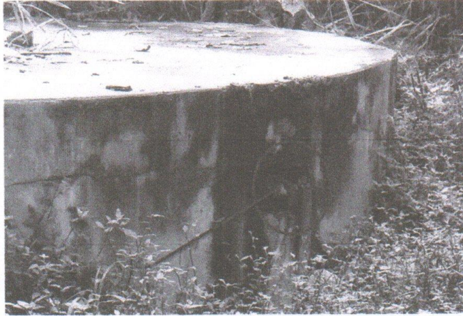
FOTO N° 05: TANQUE IMHOFFS COLAPSADO.
