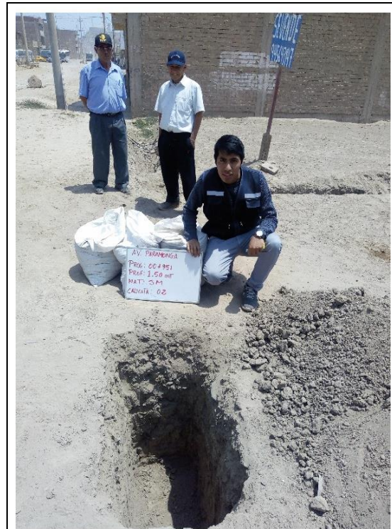
Calicata 02 : Hasta 1.50 m de profundidad presenta suelo de un solo extracto de clasificación SUCS – CL.
