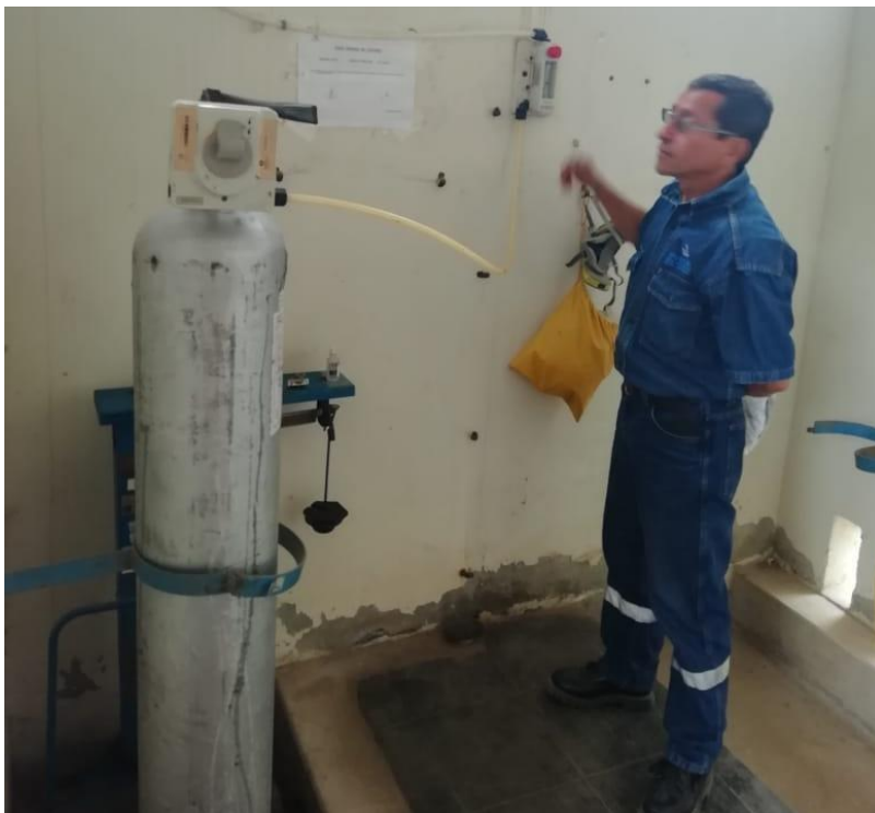
Imagen 2. Sistema de Cloración en Reservorio Buenos Aires
