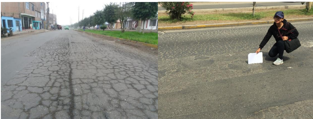
Agrietamiento en Bloque
