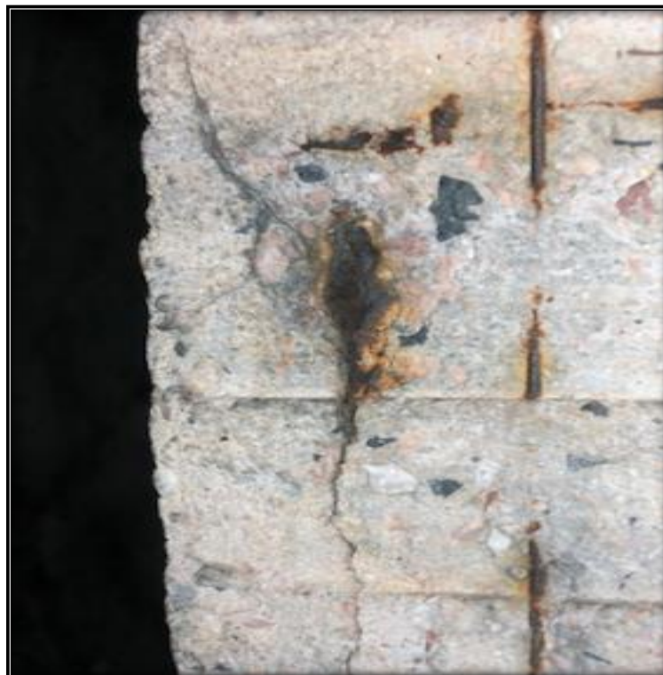
Figura N° 1: Garcés, P. Corrosión de armaduras en estructuras de hormigón armado
