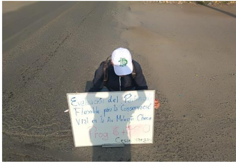
Figura 27. Progresiva 6+780, falla de piel de cocodrilo y grietas de contracción
