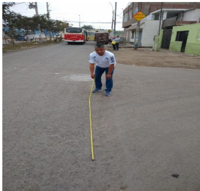
Figura 18. Progresiva 7+110, falla de desprendimiento de material
