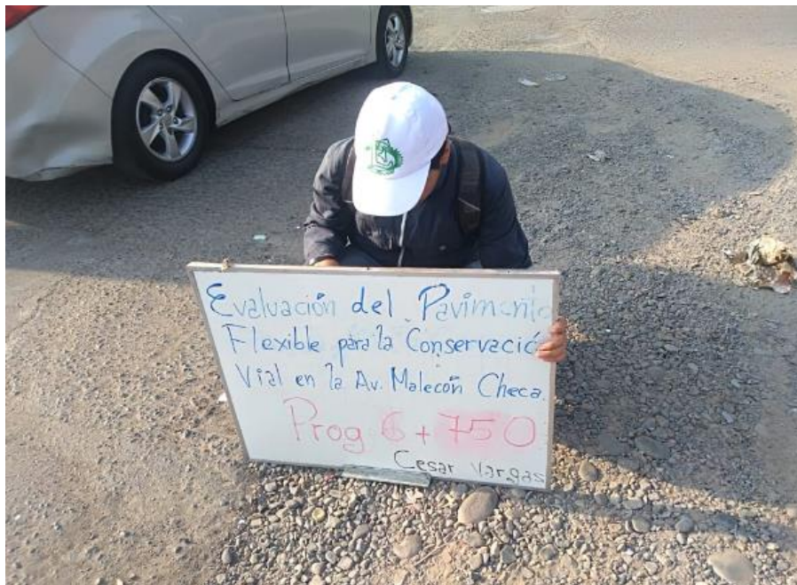
Figura 28. Progresiva 6+750, falla de desprendimiento total.
