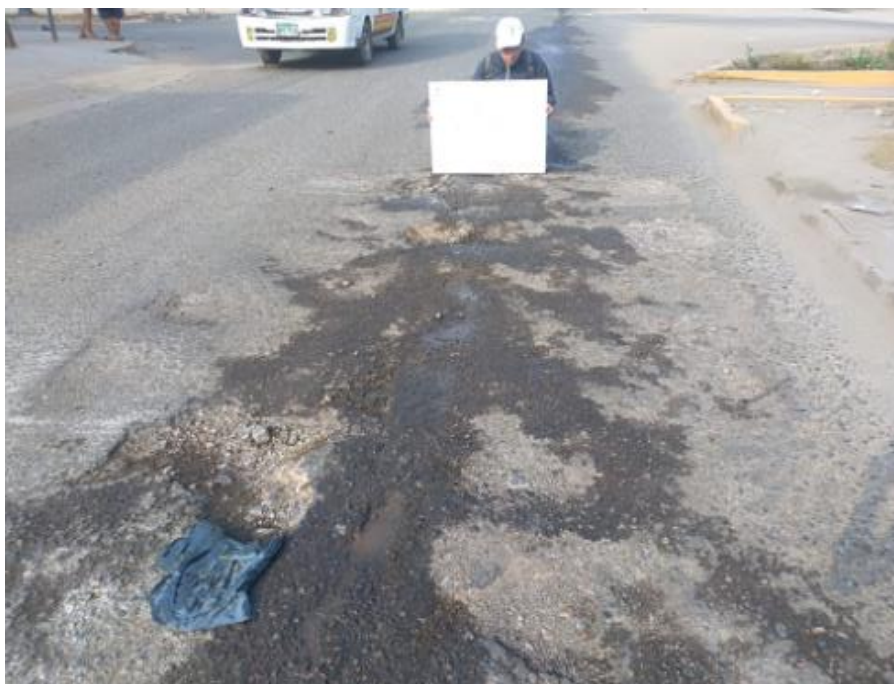
Figura 20. Progresiva 6+990, falla de bache y desprendimiento de material
