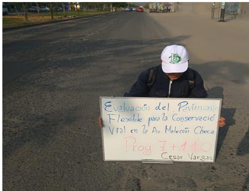
Figura 16. Progresiva 7+110, falla longitudinal
