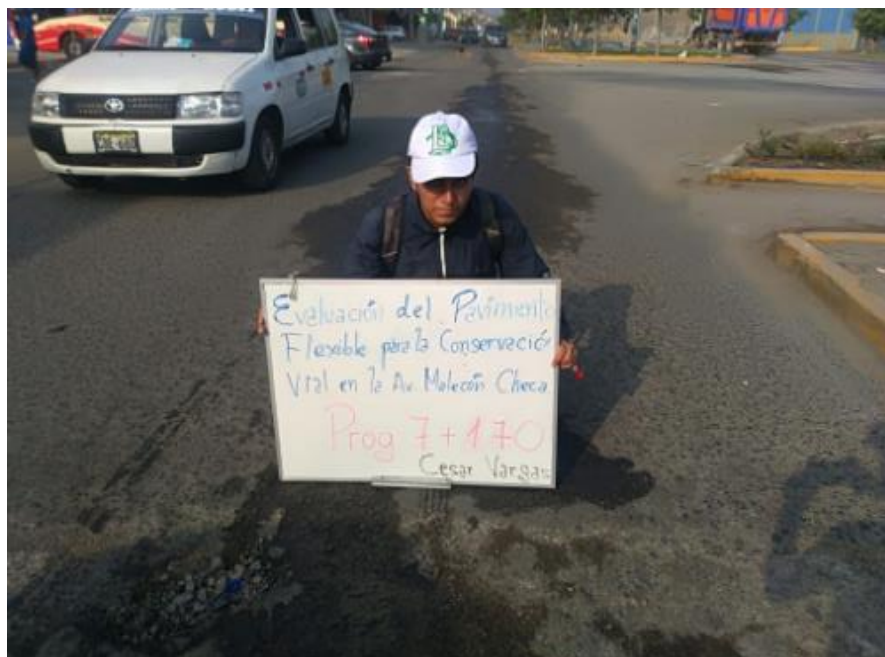
Figura 14. Progresiva 7+170, falla de piel de cocodrilo
