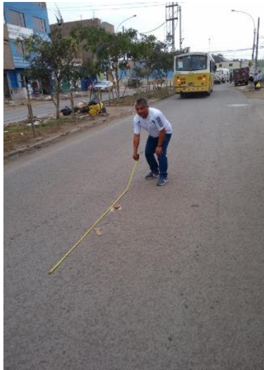
Figura 23. Progresiva 6+900, falla de piel de cocodrilo y grietas de borde
