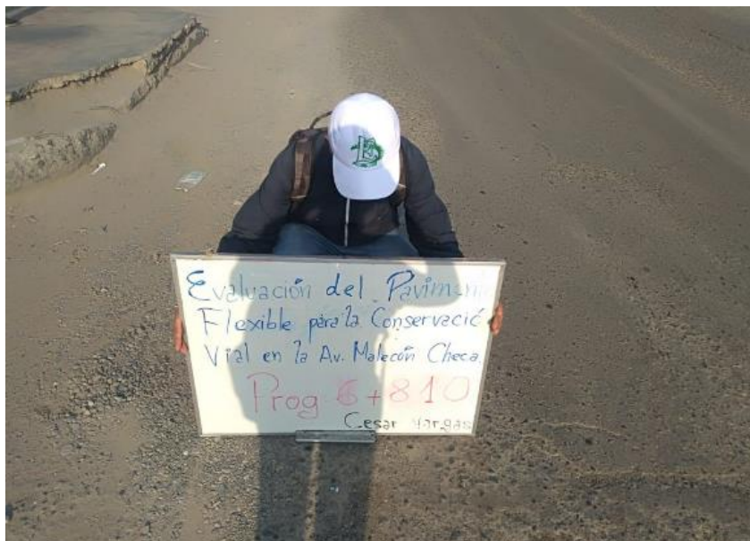
Figura 26. Progresiva 6+810, falla de piel de cocodrilo y desprendimiento de material
