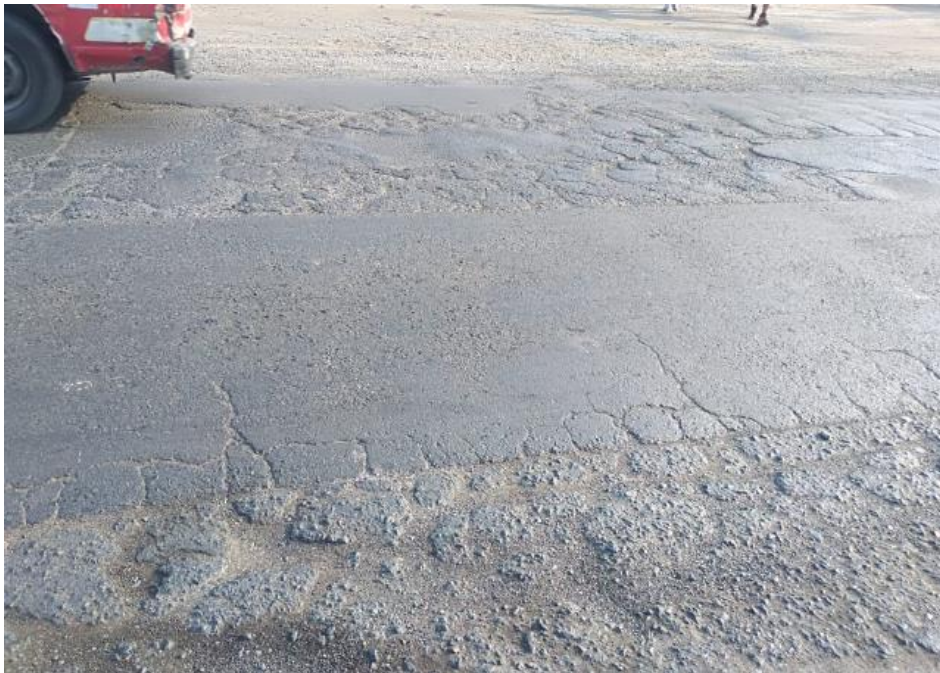
Figura 33. Patologías en la Av. Malecón Checa
