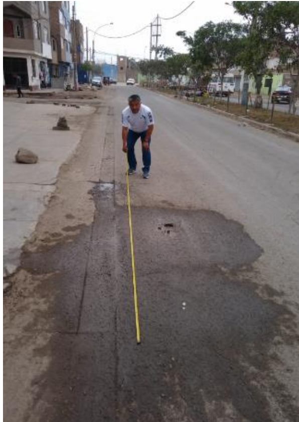
Figura 31. Progresiva 6+660, falla de piel de cocodrilo
