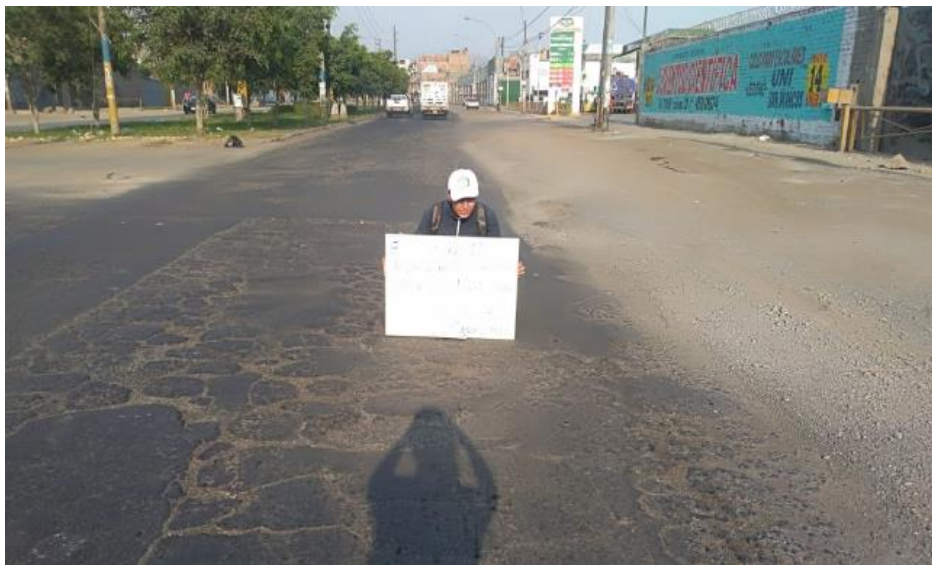
Figura 22. Progresiva 6+930, falla de piel de cocodrilo, y parche.
