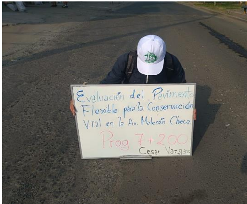
Figura 13. Progresiva 7+200, falla de piel de cocodrilo
