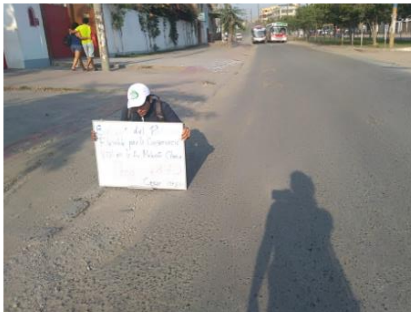
Figura 24. Progresiva 6+870, falla de grietas de borde
