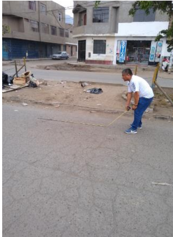
Figura 21. Progresiva 6+960, falla de ahuellamiento y contracción
