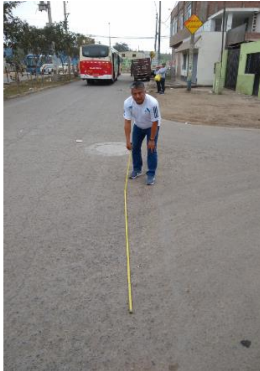
Figura 25. Progresiva 6+680, falla de piel de cocodrilo y baches
