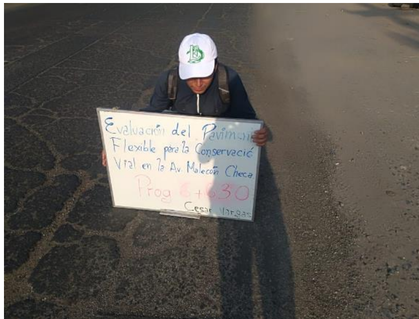
Figura 32. Progresiva 6+630, falla de piel de cocodrilo y grietas de borde
