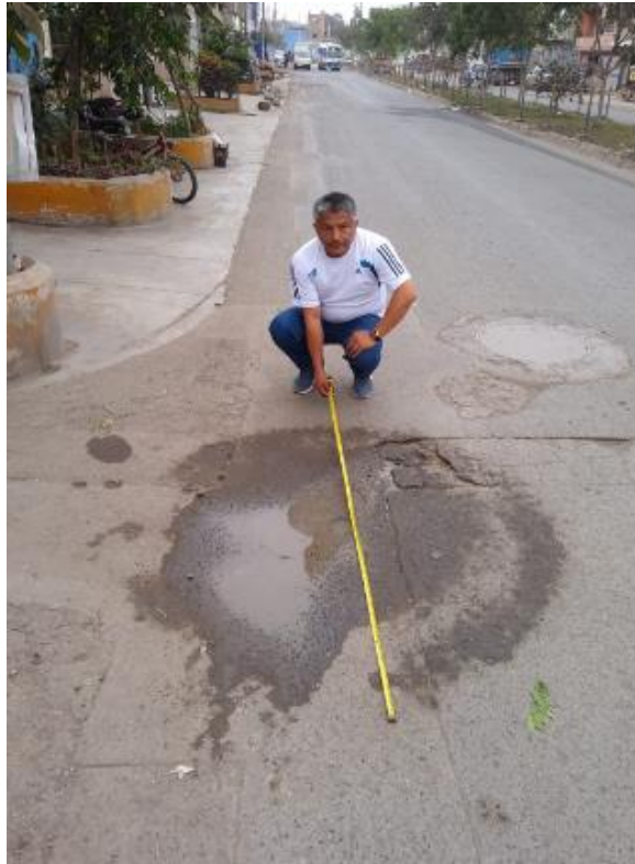
Figura 29. Progresiva 6+720, falla de piel de cocodrilo y parches
