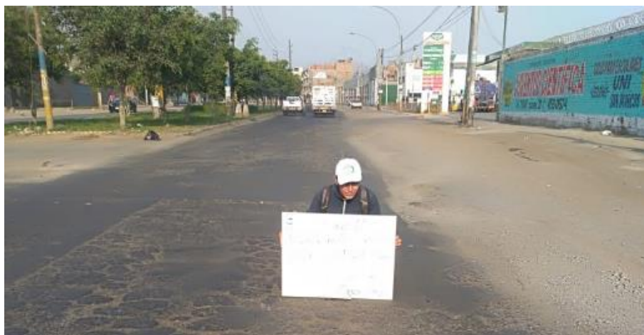
Figura 8. Fallas en la Av. Malecón Checa
