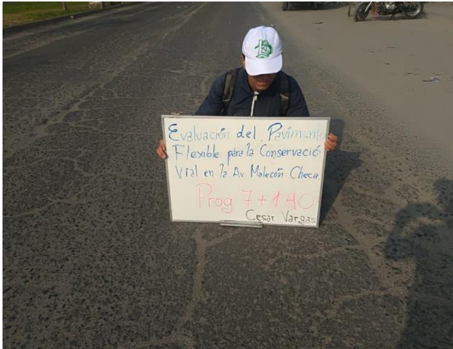
Figura 15. Progresiva 7+140, falla de piel de cocodrilo
