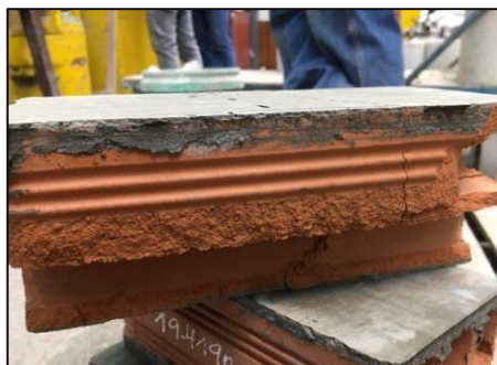
Figura 32. Falla por trituración en unidades tubulares
