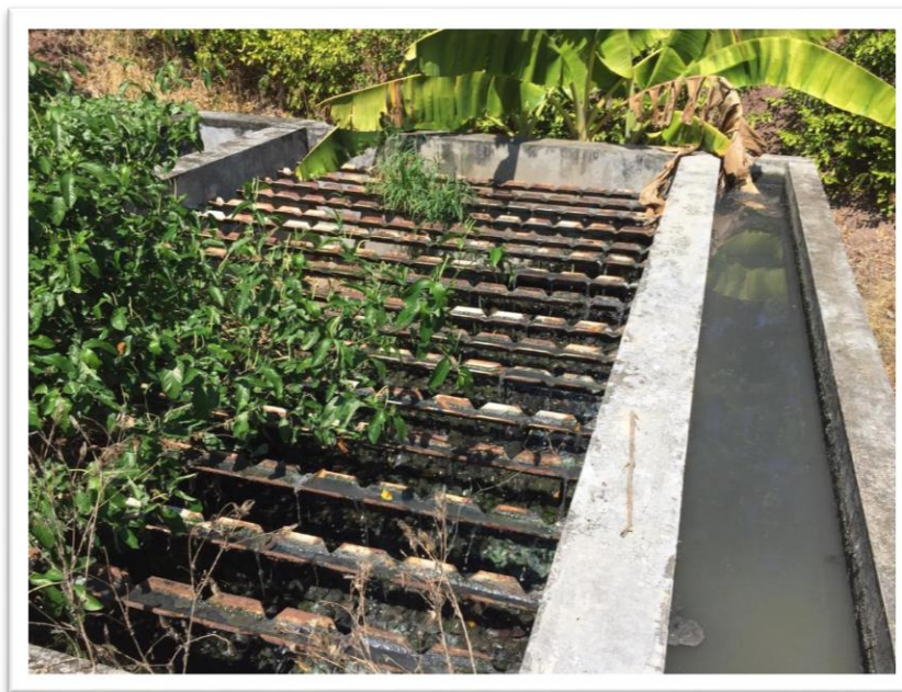
Imagen N° 10: Cámara de lodos trabajando.
