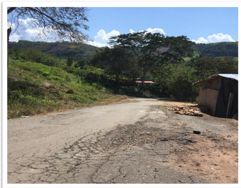
Imagen N° 02: Muéstrase la vía que nos permite acceder a la localidad de Maceda. Donde se logra visualizar las fallas que presenta la carpeta de rodadura. Y esto sea
