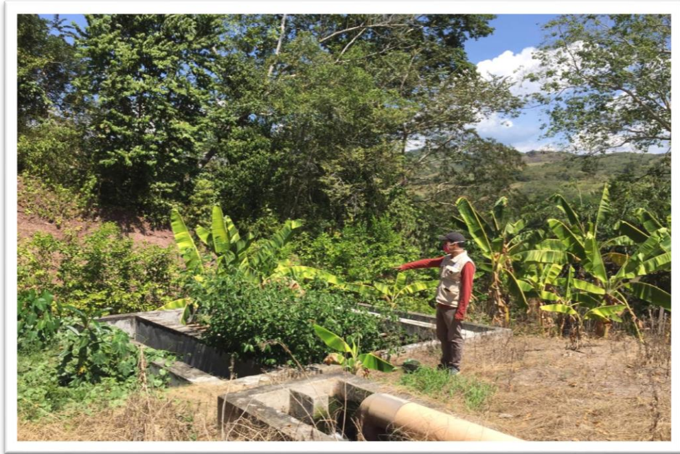
Imagen N° 09: Se muestra la cámara de lodos. Donde por efecto reboce se adquiere la separación del agua y el lodo.
