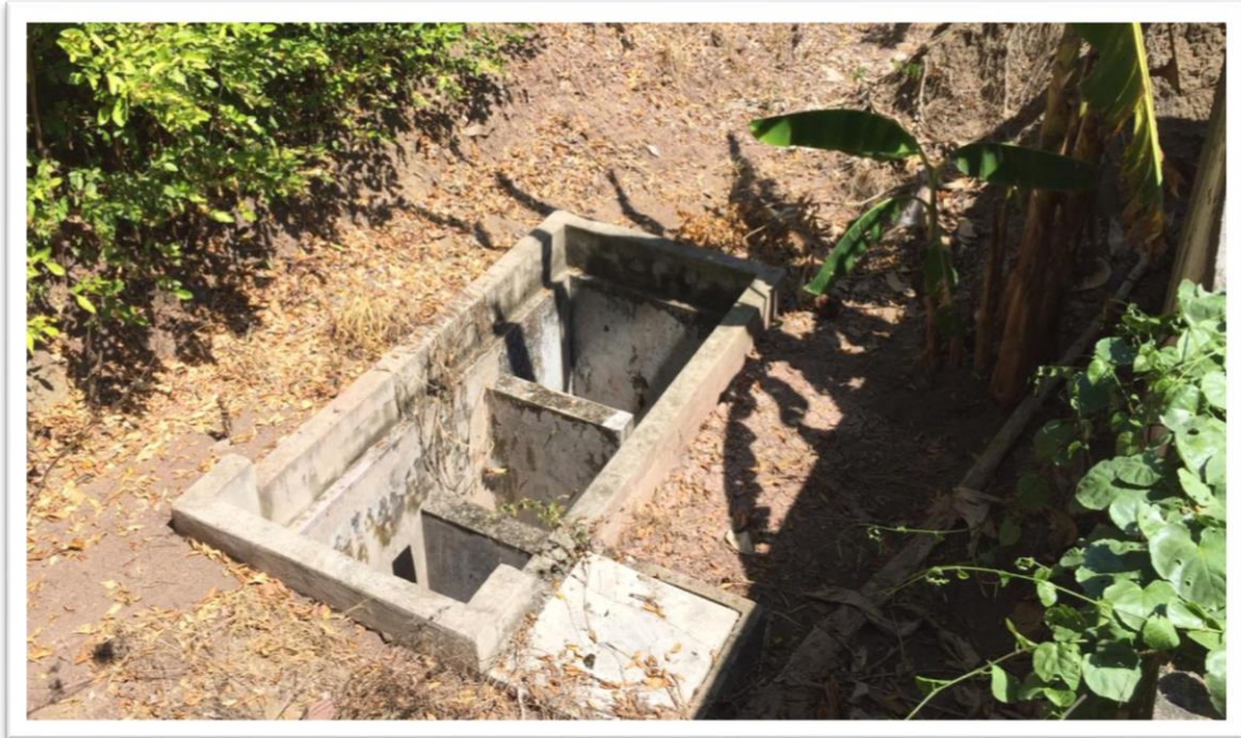
Imagen N° 11: Cámara de limpieza.
