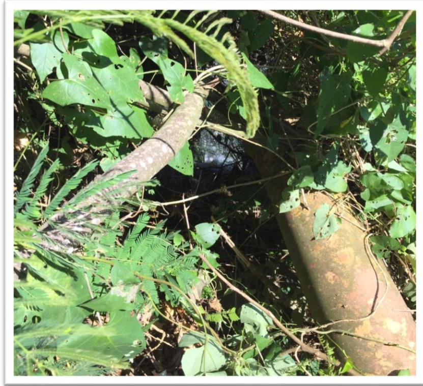
Imagen N° 13: Se logra observar la tubería que conduce el líquido tratado, para este ser dispuesto en una afluyente.
