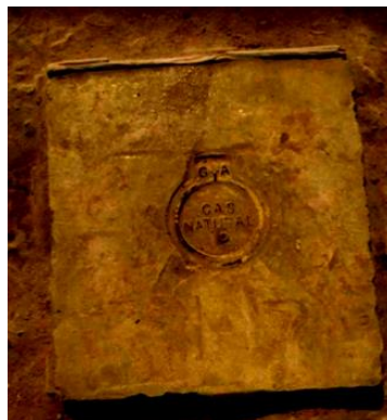
Imagen n° 145 Fotografía de Servicios básicos de Gas Natural
