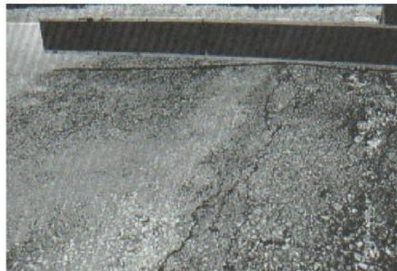
Figura 6 Falla tipo abultamiento
