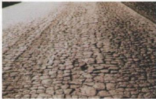
Figura 3 Falla tipo piel de cocodrilo
