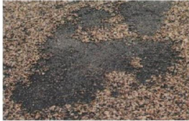
Figura 23 Falla tipo desprendimiento de agregado
