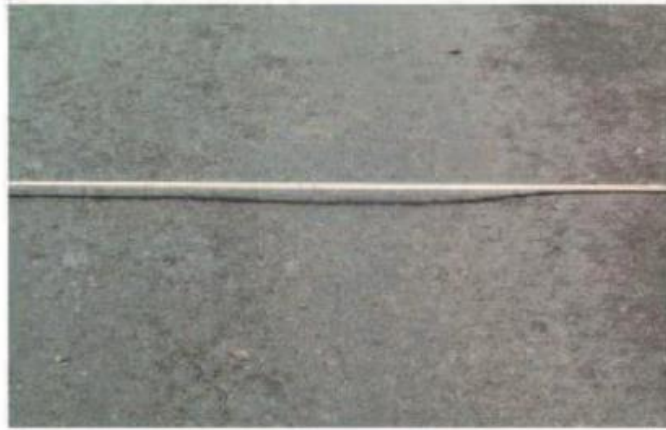
Figura 7 Falla tipo hundimiento
