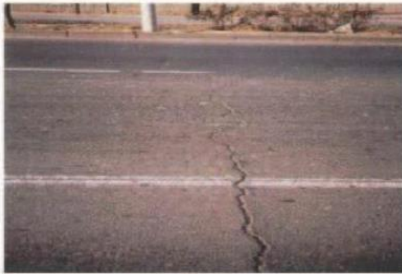
Figura 14 Falla por grieta transversales
