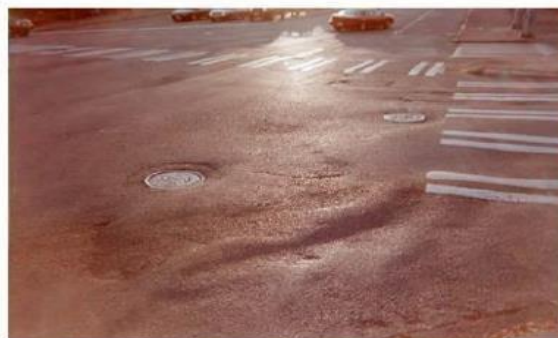
Figura 20 Falla por desplazamiento
