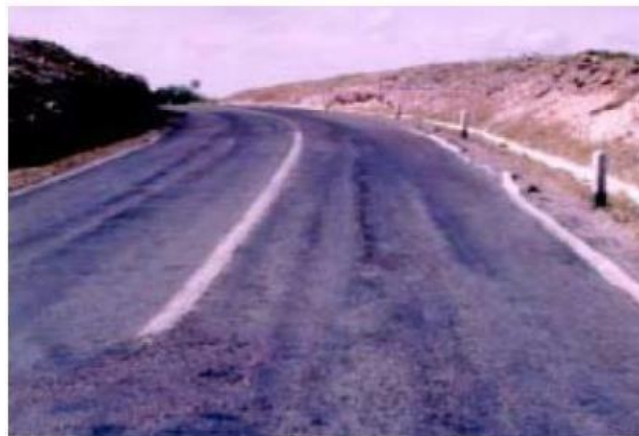
Figura 22 Falla tipo hinchamiento
