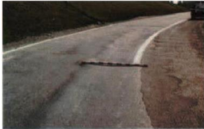
Figura 19 Falla por ahuellamiento
