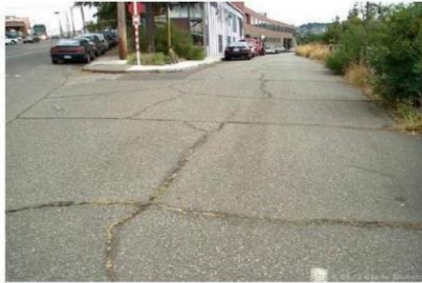
Figura 11 Falla por grieta de reflexión de junta
