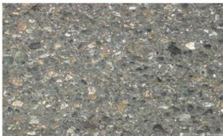
Figura 16 falla tipo pulimento de agregados
