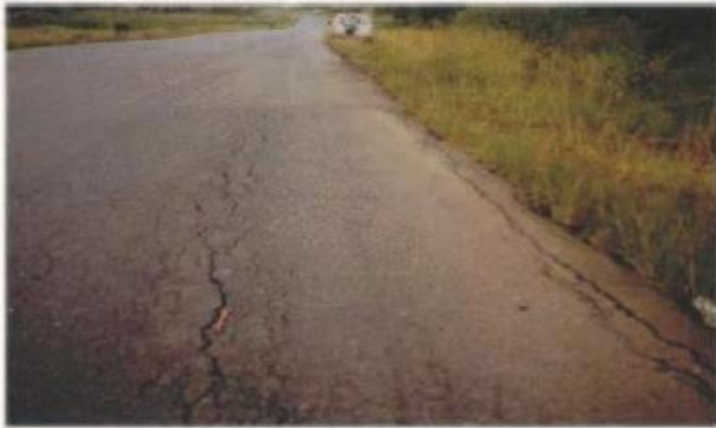
Figura 13 Falla por grietas longitudinales
