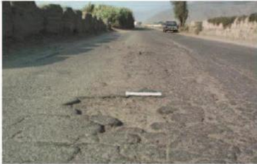
Figura 17 Falla tipo huecos
