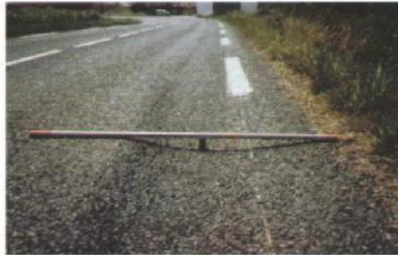
Figura 9 Falla por depresión
