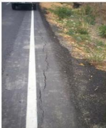
Figura 10 Falla por grieta en borde
