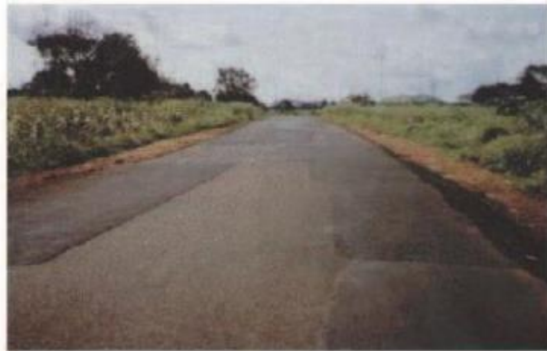
Figura 15 Falla tipo parches
