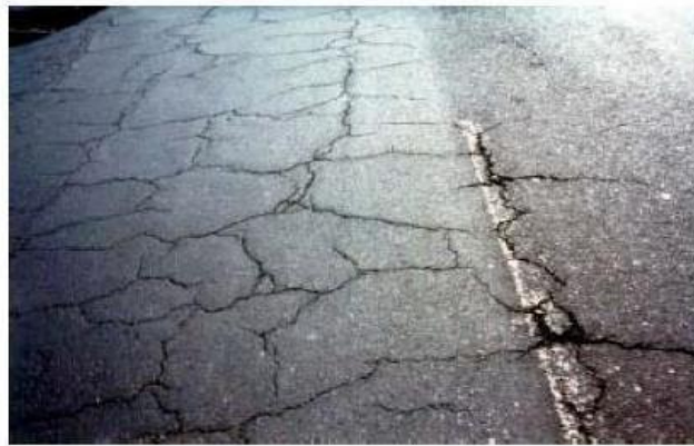
Figura 5 Falla por agrietamiento en bloque
