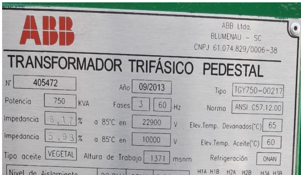
Figura 22: Datos de la placa de transformadores del Templo Mormón de Trujillo.
