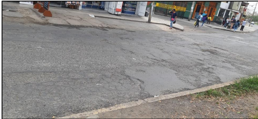
Figura N° 2: Estado actual del pavimento Av. Lima - San Juan de Lurigancho.
