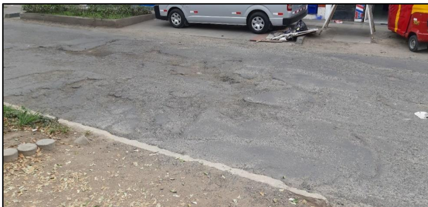
Figura N° 4: Deterioro por fatiga, reflexión del pavimento Av. Lima San Juan de Lurigancho
