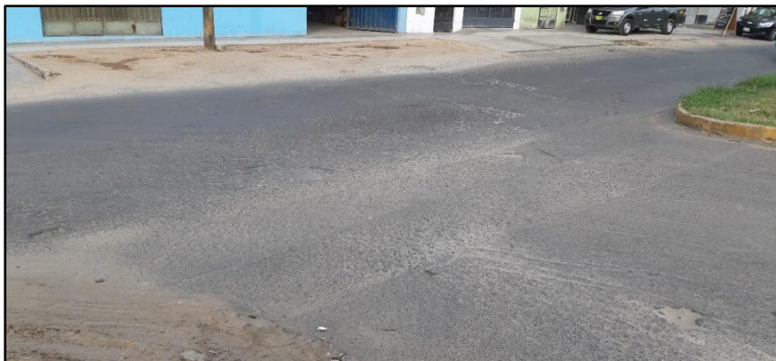
Figura N° 3: Fallas por envejecimiento del pavimento Av. Lima San Juan de Lurigancho.
