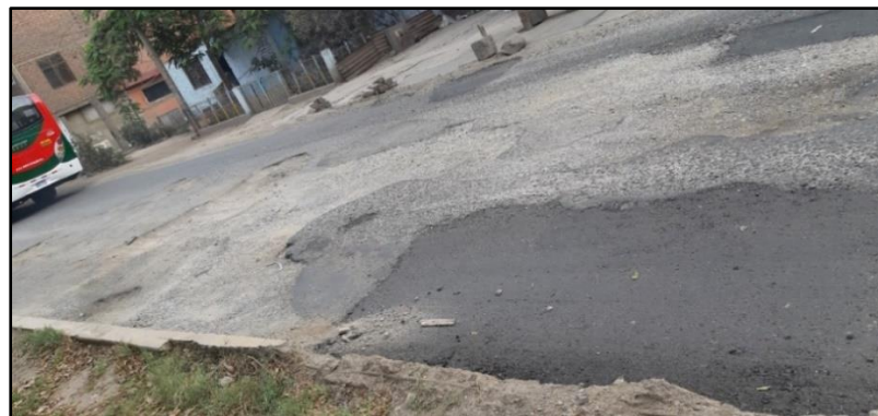
Figura N° 1: Estado actual del pavimento Av. Lima - San Juan de Lurigancho.
