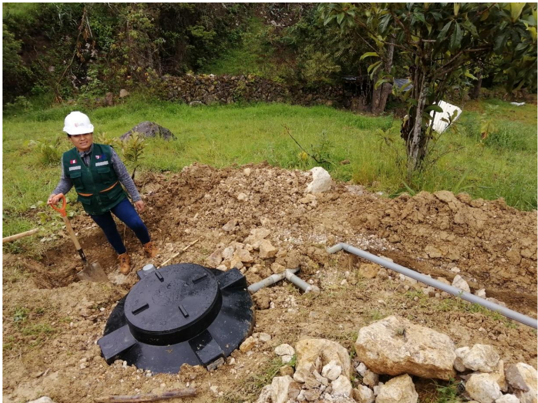
FOTO N° 15: vista del ingreso de aguas residuales al biodigestor, salida de liquidos y salida de lodos tratados.
