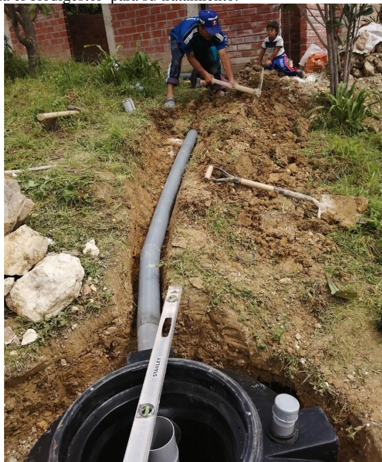
FOTO N° 11. apreciación de las conexiones de tuvos para el desague que sale de la caseta hacia el biodigestor para su tratamiento.
