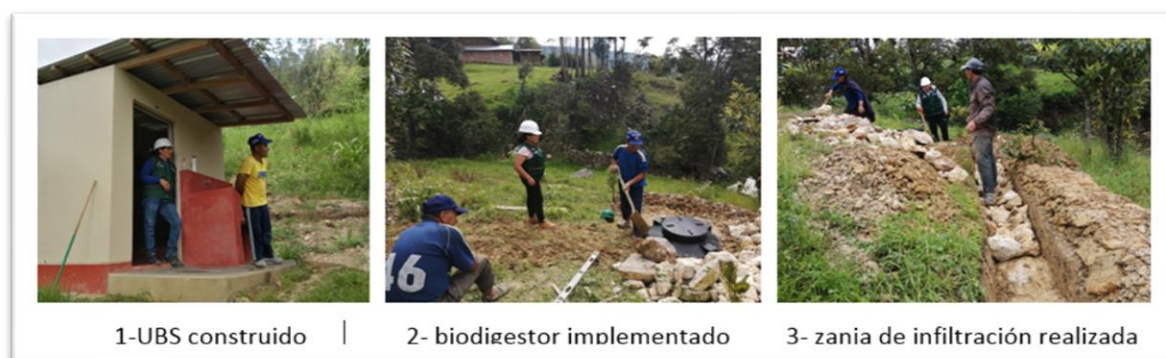
Figura 16. Implementación de la unidad básica sanitaria con arrastre hidráulico.
