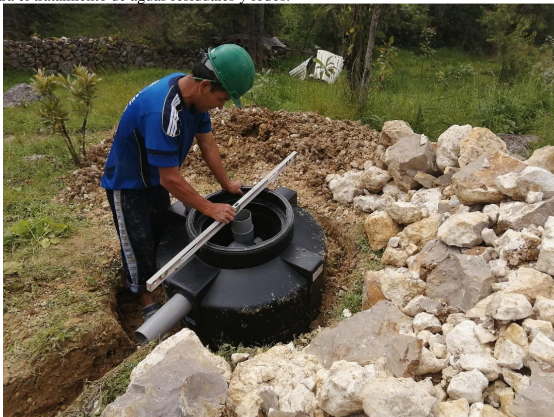
FOTO N° 12: utilizando un nivel para la ubicación adecuada del biodigestor prefabricado para el tratamiento de aguas residuales y lodos.
