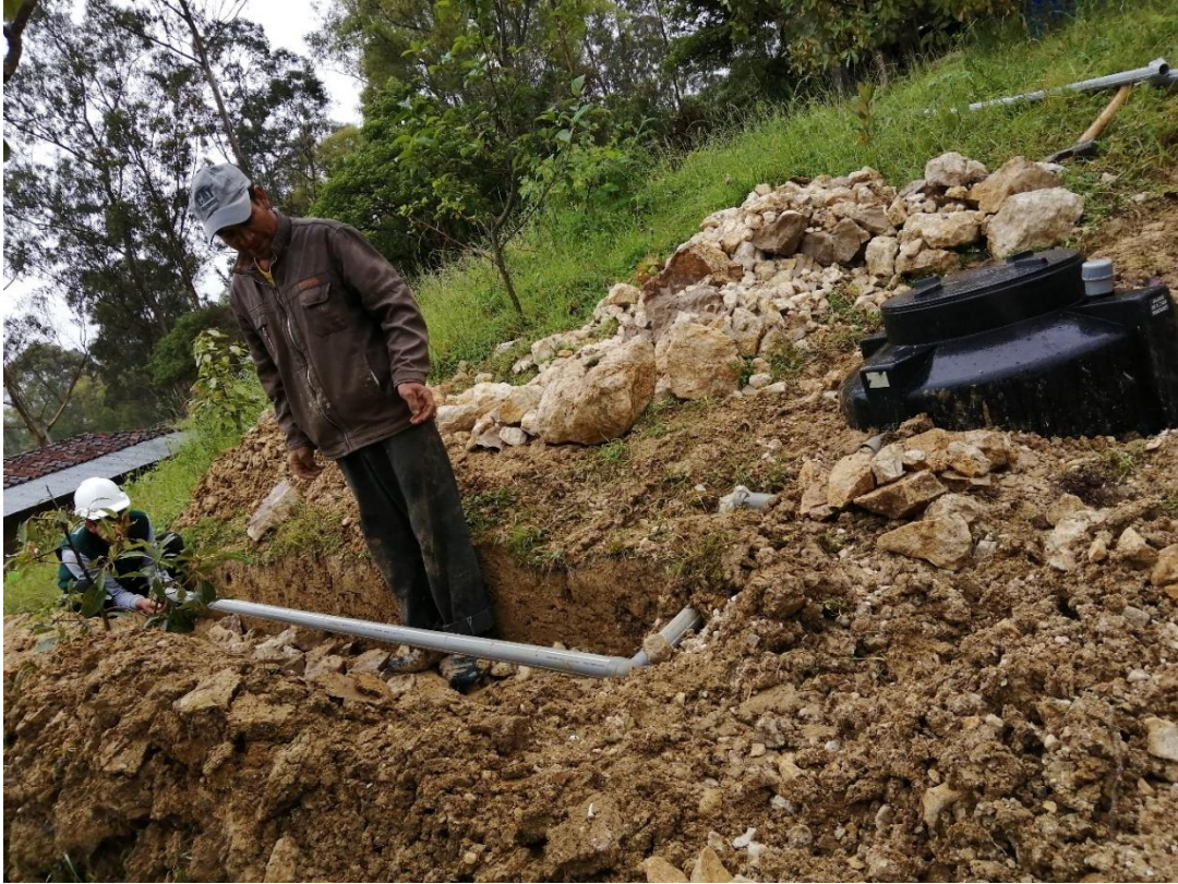
FOTO N° 14: intalacion de la salida de liquidps tratadps del biodigestor a la sanja de infiltracion.
