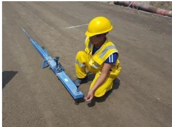
Figura 47. Deflexión del pavimento.
