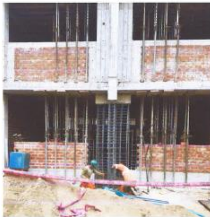
Eliminación total del concreto en columna
