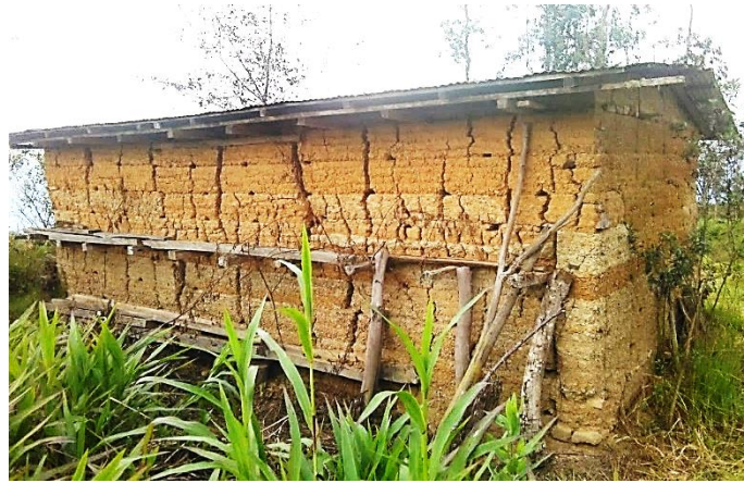
Figura 1: Grietas y fisuras en vivienda de tapial de 2 pisos en el C.P San Martin de Porras
