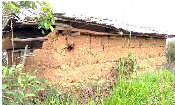
Figura 2: Colapso de muros debido a falta de refuerzo y confinamiento
