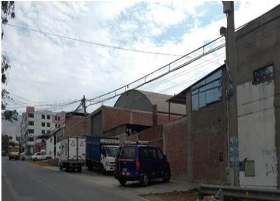
Figura 0.4.- Desgaste de la carpeta asfáltica por el tránsito pesado. Fuente: elaboración propia
