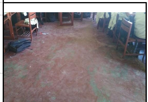
El piso de las aulas no da buena estética a los ambientes de las aulas por las fisuras que presentan.
