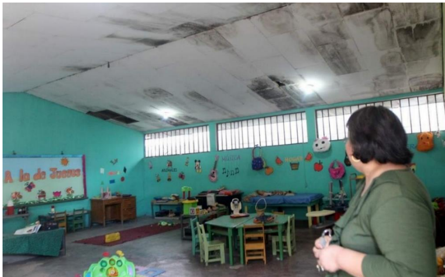
AULAS PRESENTAN UN MAL ESTADO.
