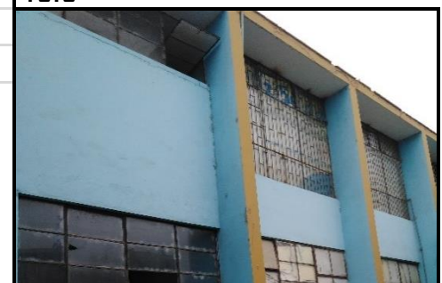
Algunas columnas se encuentran gravemente dañadas
