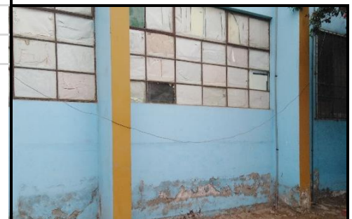
Se encuentra en deterioro y carece de mantenimiento
