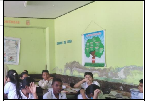
Presencia de salitre en los muros
