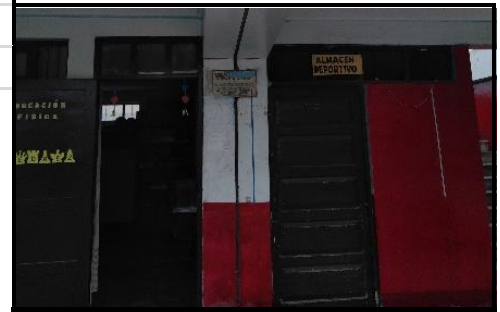
Estado de conservación en que se encuentra las Aulas de Tipo 1.
