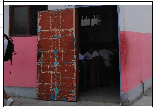
Todas las aulas pegan en las puertas decoraciones que con el tiempo dañan a la puerta.
