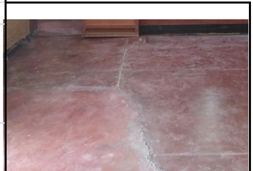
El piso de las aulas no da buena estética a los ambientes de las aulas por las fisuras que presentan.
