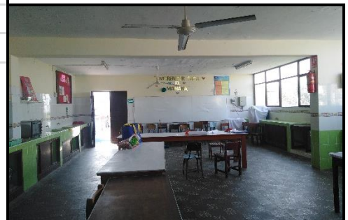
No se presentan ningún problema grave en sus estructuras sin embargo tienen un mal cuidado
