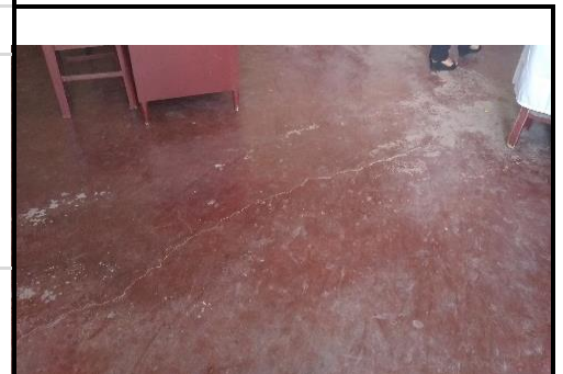
Piso e color rojo teja que presenta fisuras dando mala presencia al lugar
