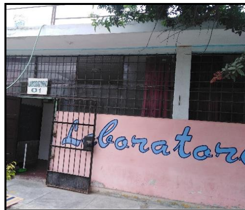
Cuenta con problemas de deterioro y falta de mantenimiento
