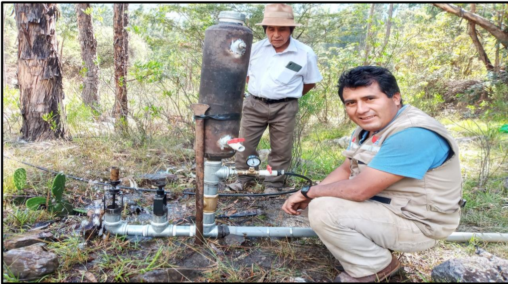
Fotografía 1. Instalación de la bomba ariete
