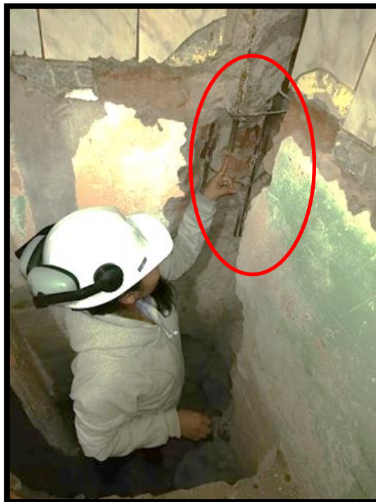
Figura 2: Falla estructural en un edificio multifamiliar – Villa María Del Triunfo
