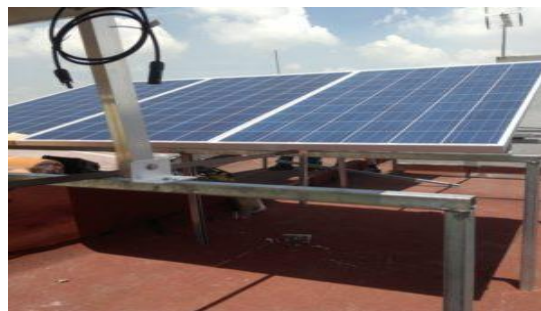
Figura 7. Módulos o paneles solares.
