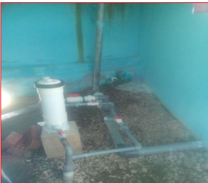
Fotografía 07: valvulas de control del reservorio existente
